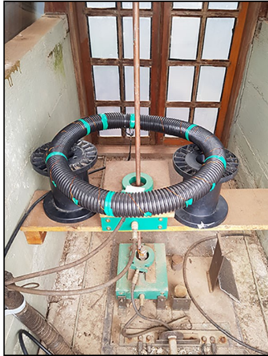
Figura 3.25 – Bobina de Rogowski instalada em MCS.
