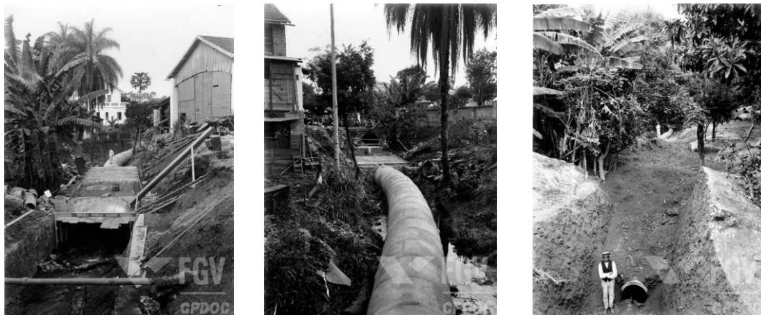
Figuras 56, 57 e 58 – Drenos no antigo leito do Córrego Acaba Mundo, atravessando por entre os lotes de particulares. Detalhe para o desnível e movimentação de terra na foto da direita.
