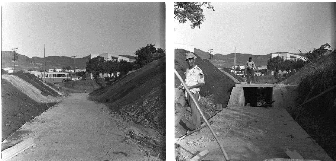
Figuras 119 e 120 – Canalização do Córrego Acaba Mundo, em 1963, na Avenida Uruguai, no cruzamento da Rua Grão Mogol (ao fundo é possível ver o prédio residencial de nº 995, dessa rua). A imagem da direita apresenta a seção da canalização em concreto armado.
