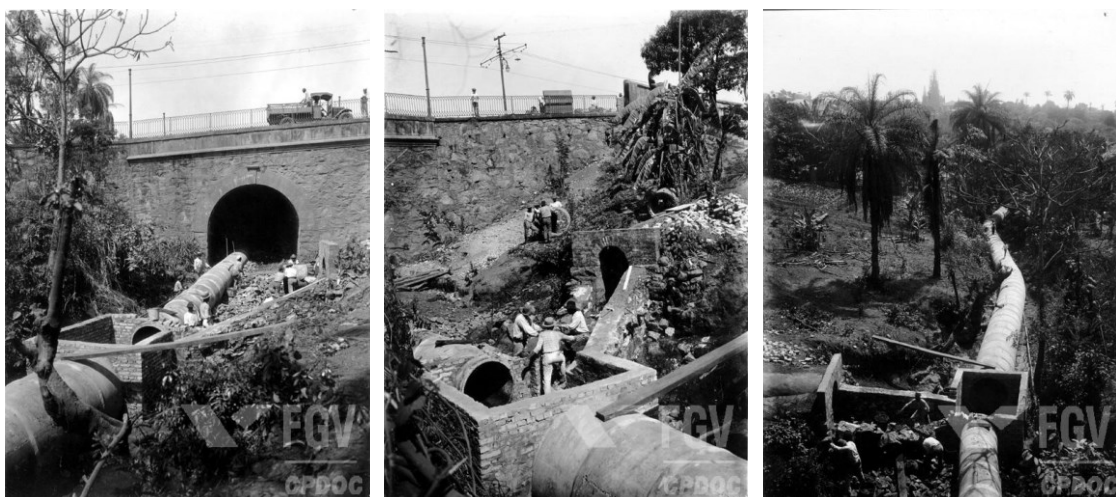
Figuras 59, 60 e 61 – Drenos no antigo leito do Córrego Acaba Mundo. À esquerda e ao centro, drenos sob a ponte-bueiro na Rua Pernambuco. À direita, drenos em região desocupada e ao fundo, a Catedral Nossa Senhora da Boa Viagem.
