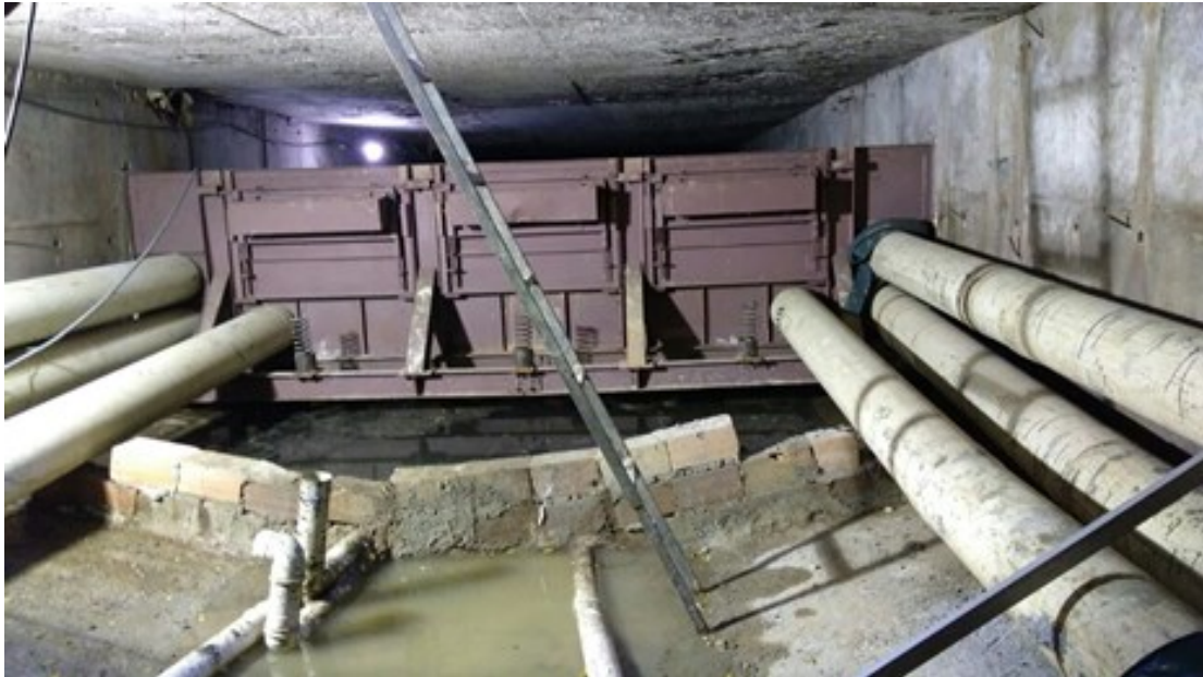
Figura 183 – Comporta metálica e tubulações para desvio da água.
