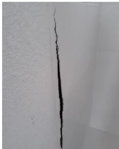
Figura 1- Descolamento do revestimento cerâmico interno na parede de concreto. Fonte: MASONE (2018).
