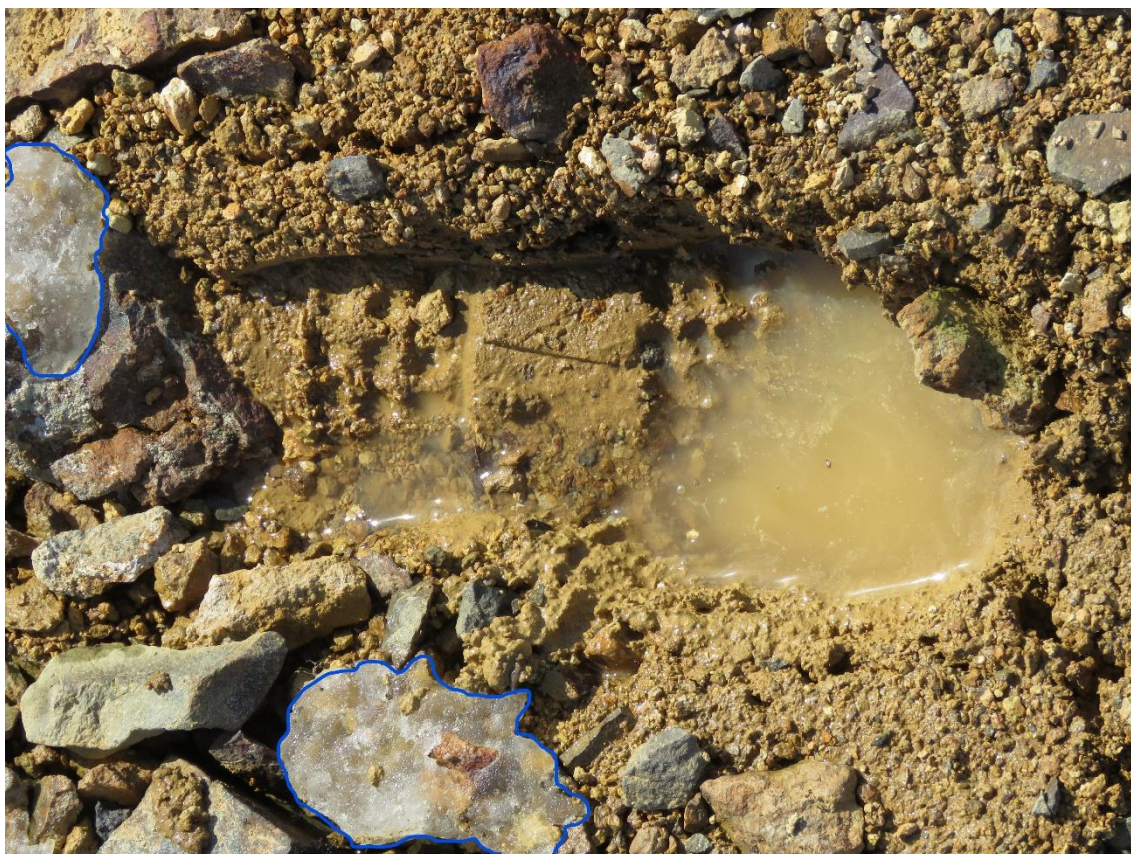
Figura 2.6 – Fotografia ilustrativa da saturação da superfície e de lentes de gelo superficial.
