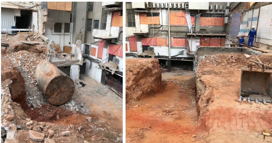
Figura 91 – Tanque de querosene e estrutura do anexo em conjunto com contenção.
