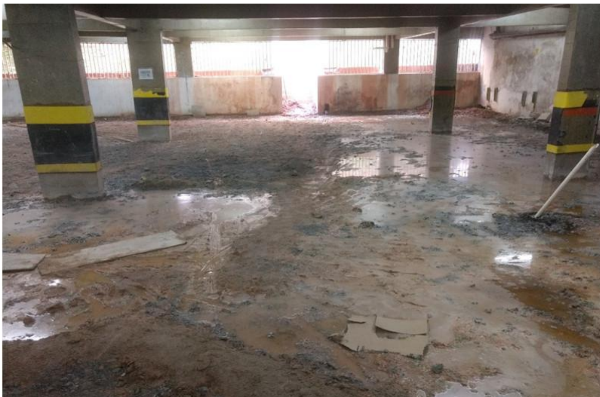
Figura 64 – Descoberta de afloramento de lençol freático sobre o piso da garagem.
