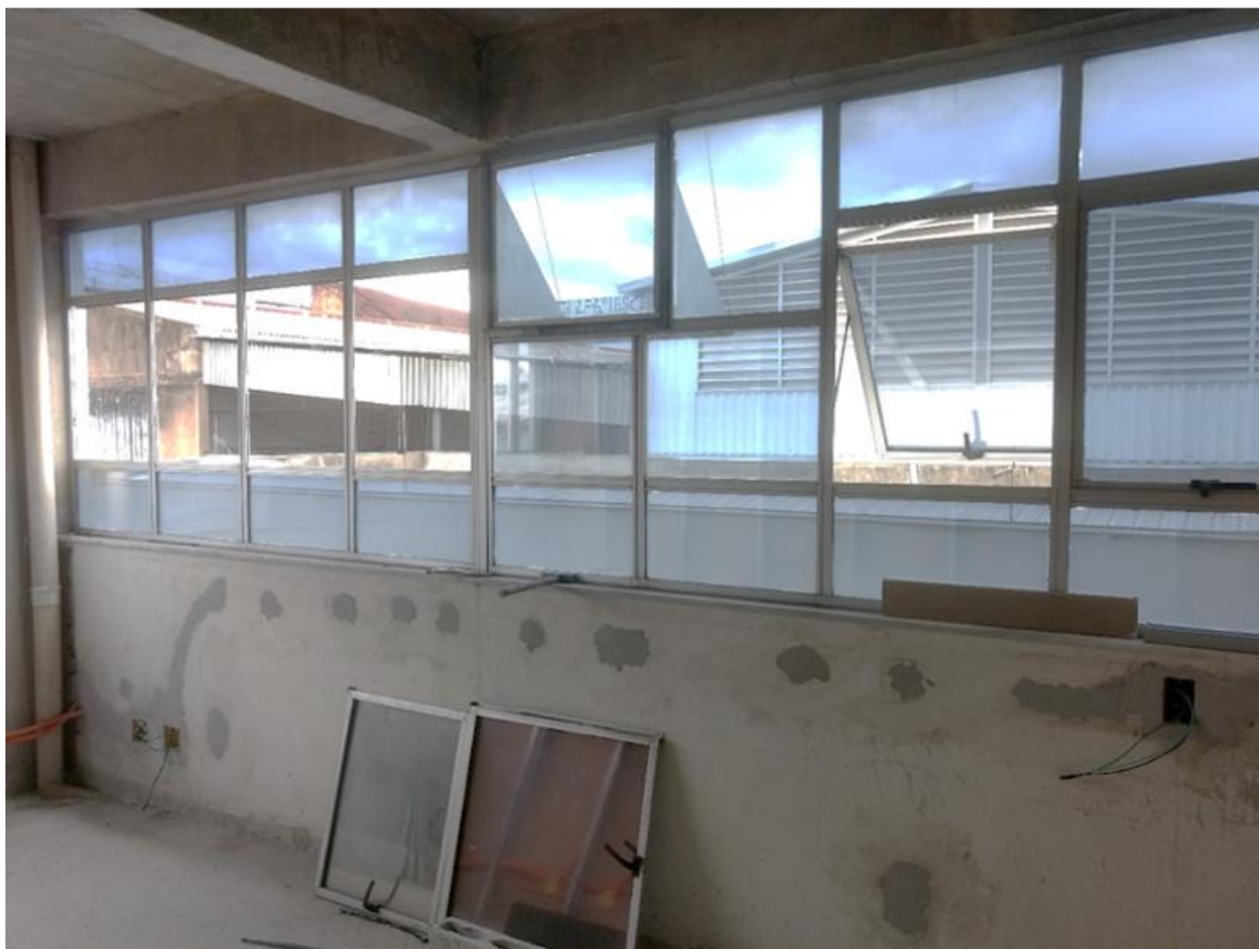
Figura 50 – Estado de conservação das esquadrias existentes.
