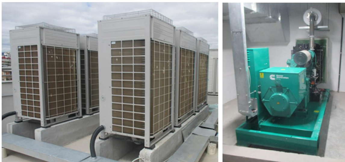
Figura 37 – Condensadoras do sistema de ar condicionado instaladas na cobertura.
