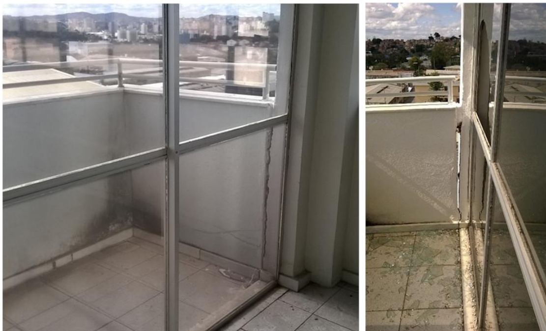
Figura 46 – Varanda fachada frontal apresentando deslocamento e avarias.
