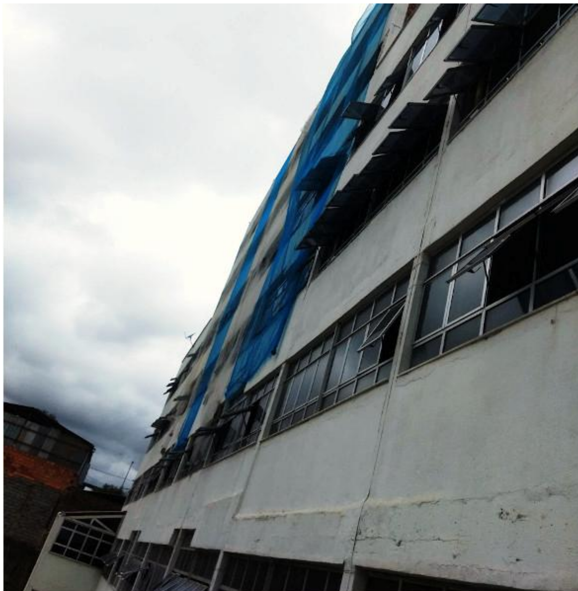
Figura 51 – Situação irregular do substrato das fachadas existentes.
