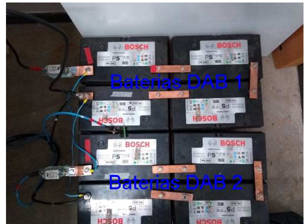
(b) Banco de baterias.
