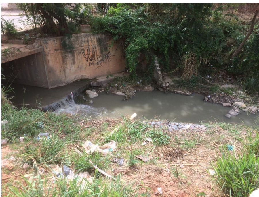
Figura 13 - Lançamento de esgotos sem tratamento no Córrego Malheiros
