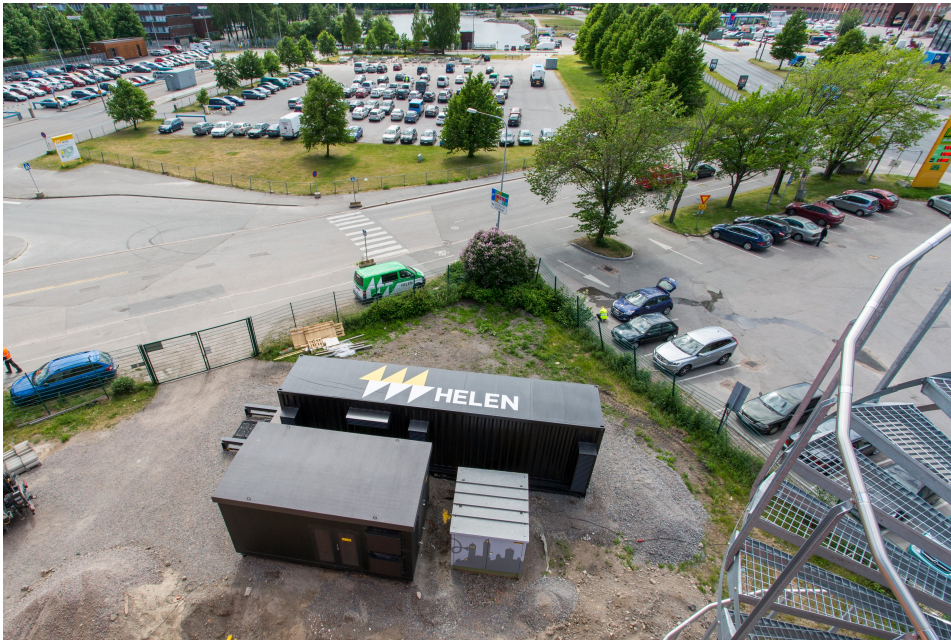
Figura 6 – Sistema de Armazenamento de Energia com Baterias instalado em Helsinque - Finlândia. Retirado de (SYSFLEX, 2019).
