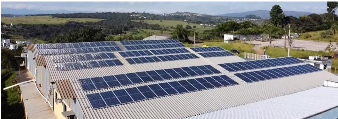
Figura 6 - Disposição dos Módulos Fotovoltaicos da Usina
