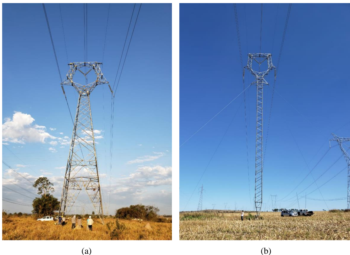
Figura 5.6 – Torre (a) autoportante e (b) estada, da linha de transmissão 230 kV, localizada próxima a cidade de Cuiabá, Mato Grosso.
