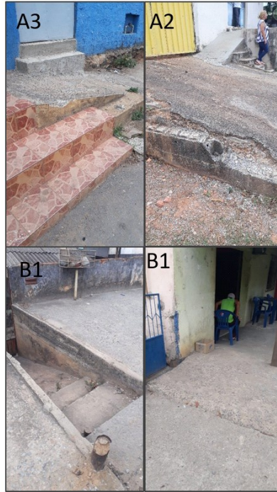
Figura 50: Exemplos de desníveis das calçadas – Trecho 2
