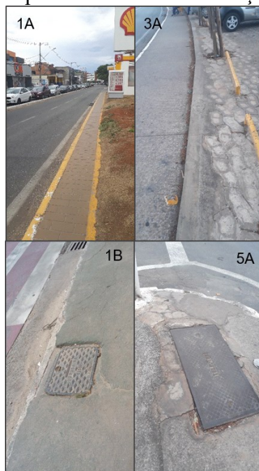
Figura 49: Exemplos de desníveis das calçadas – Trecho 1
