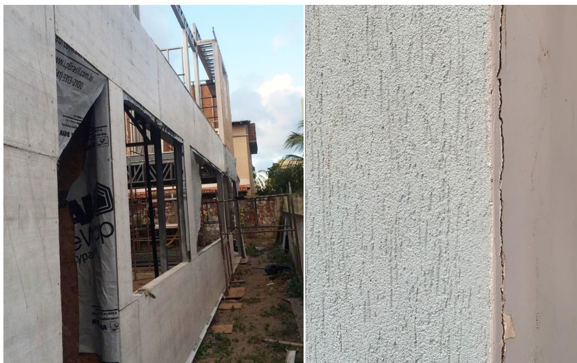
Figura 61. Residência E.F., problemas de continuidade e transições em revestimentos
