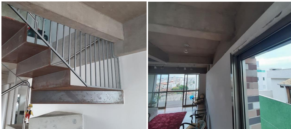
Figura 53 – Grade na escada e infiltração no apartamento de Luiz Cláudio Fonte: fotografias do autor, 2020.
