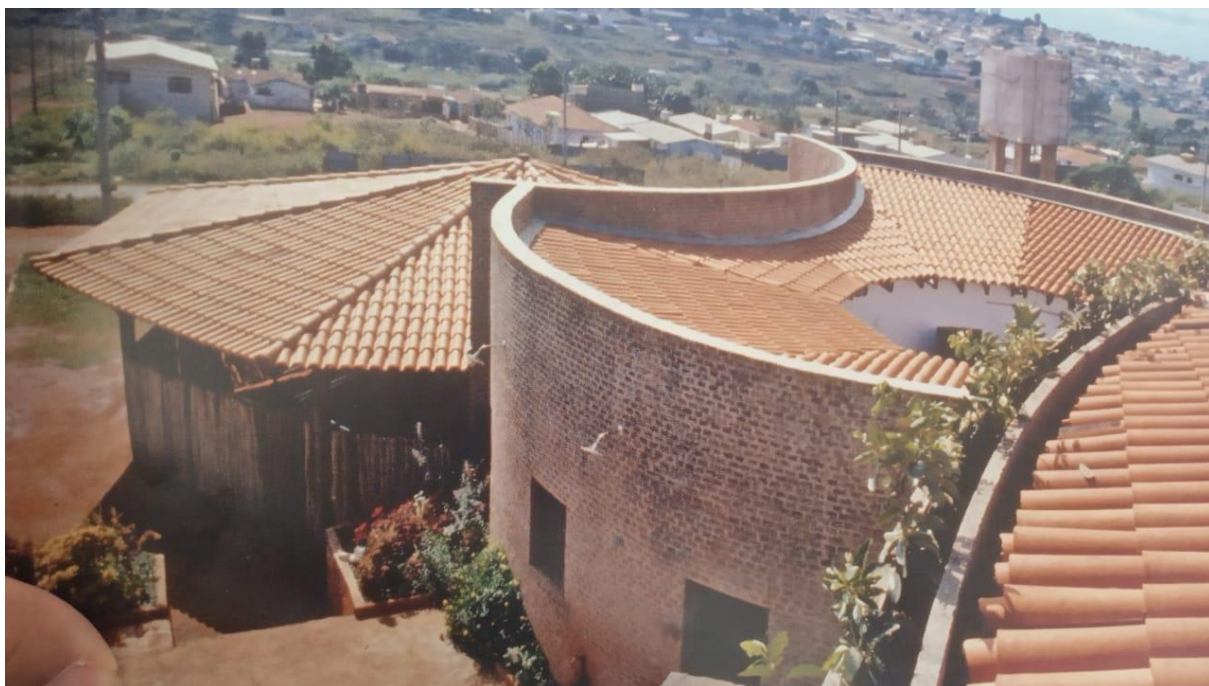
Figura 45 – Floreira na cobertura da Igreja
