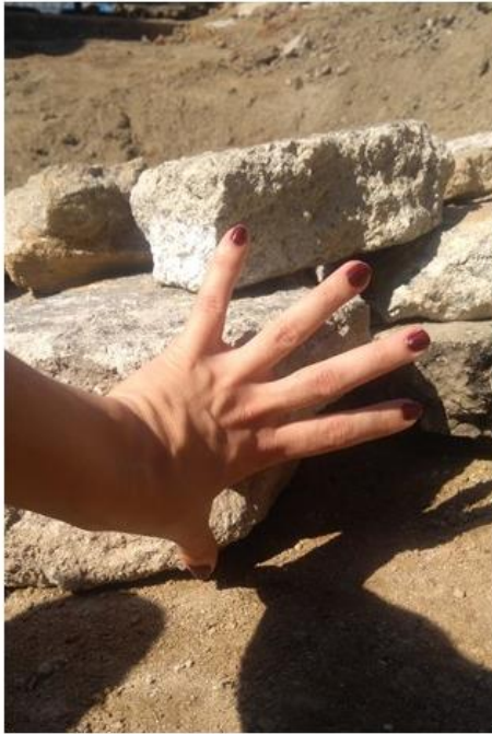
Detalhe da altura da camadas de pedra de concreto com aproximadamente 20cm
