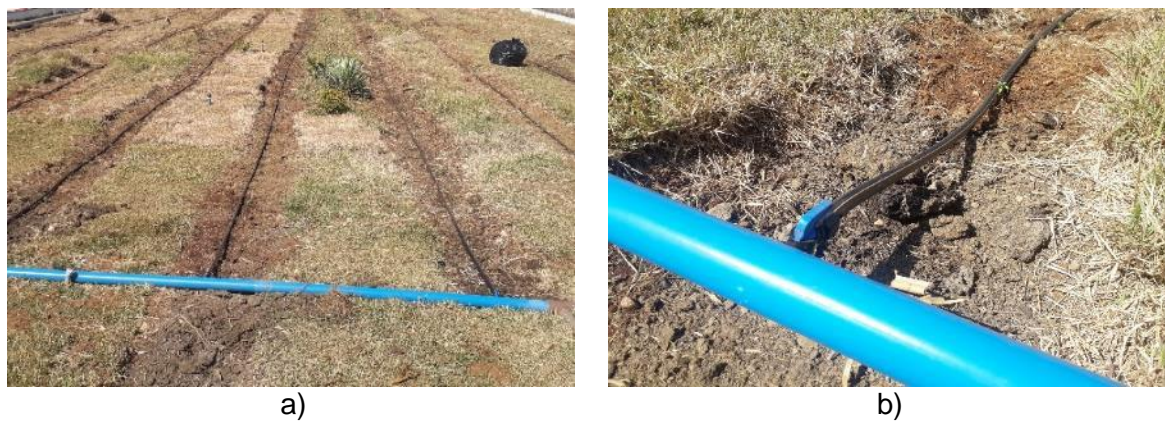
Figura 5.14 - Telhado verde extensivo com problemas de ressecamento e implantação de novo sistema de irrigação por gotejamento
