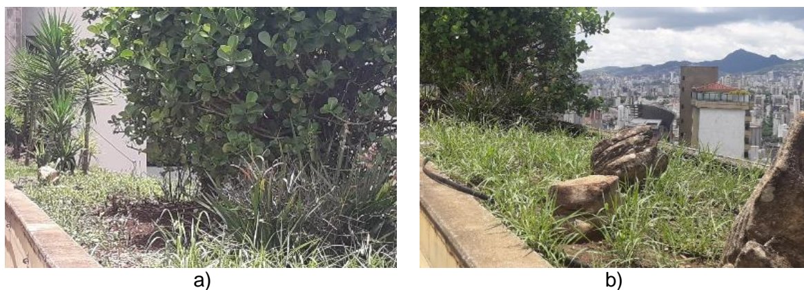
Figura 5.15 - Vegetação intrusa por falta de manutenção periódica
