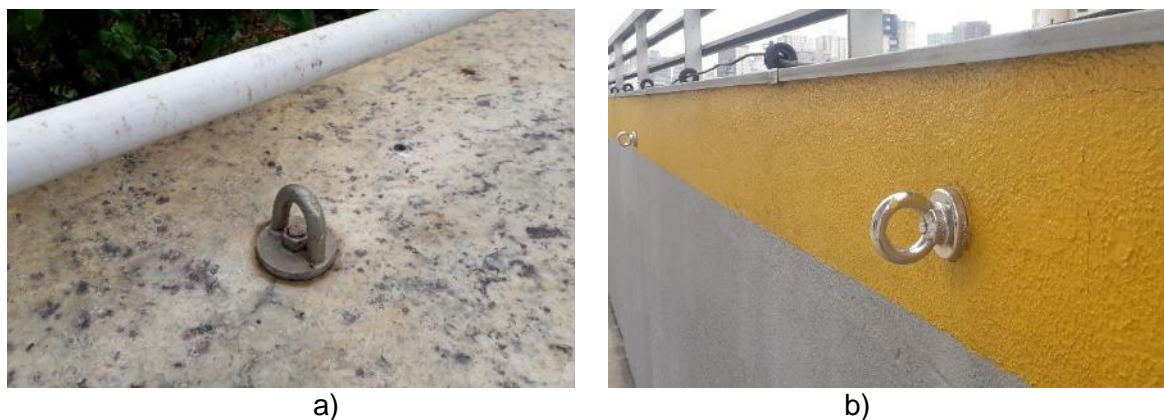
Figura 5.20 – Dispositivos de ancoragem para segurança em trabalho à altura (Conforme orientações da NR18 e NR35)
