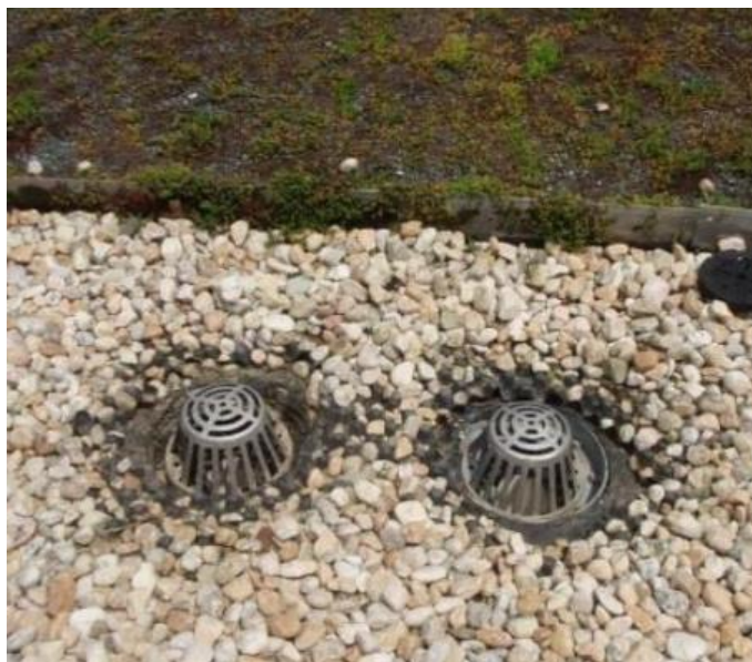
Figura 3.24 - Coletor de águas pluviais
