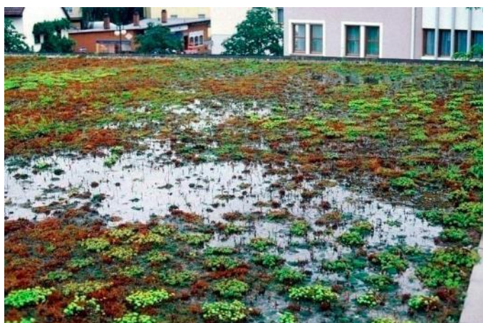
Figura 3.66 – Telhado verde com problemas de encharcamento e sobre carga
