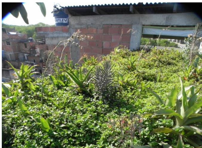
Figura 3.34 - Cobertura com telhas de fibrocimento e inclinação de 5% recoberto de vegetação no sistema de telhado verde tropical experimental hidropônico implantado na favela do Arará no Rio de Janeiro
