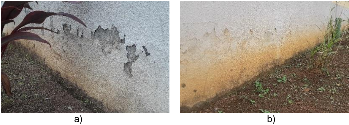
Figura 5.9 - Umidade ascendente e/ou por condensação
