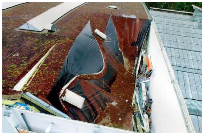
Figura 3.48 - Colapso da estrutura devido à sobrecarga
