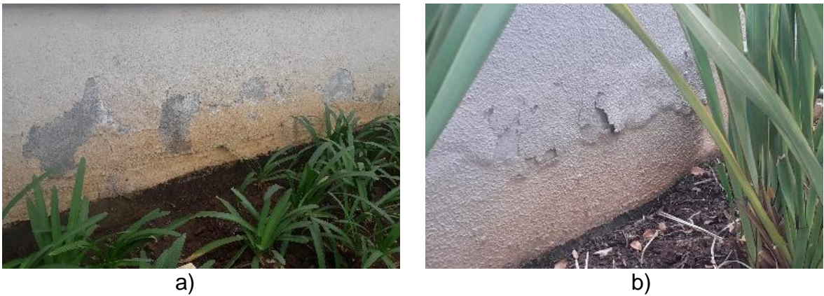
Figura 5.10 - Umidade ascendente e/ou por condensação
