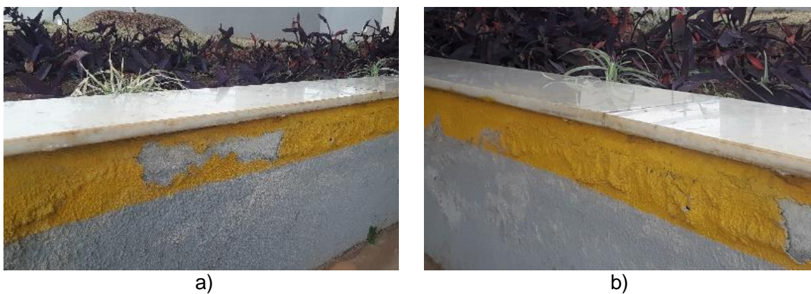
Figura 5.16 - Umidade de infiltração negativa
