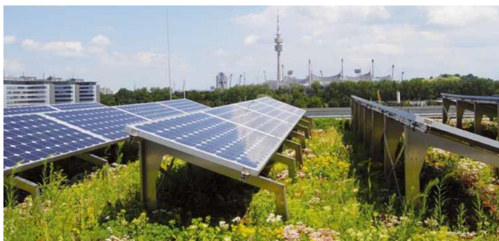
Figura 3.37 - Interação de painéis de energia solar em telhado verde
