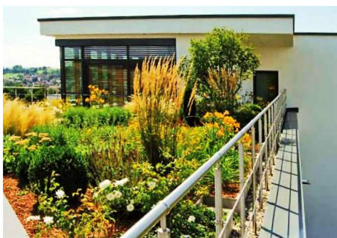
Figura 3.51 - Guarda corpo para proteção contra queda
