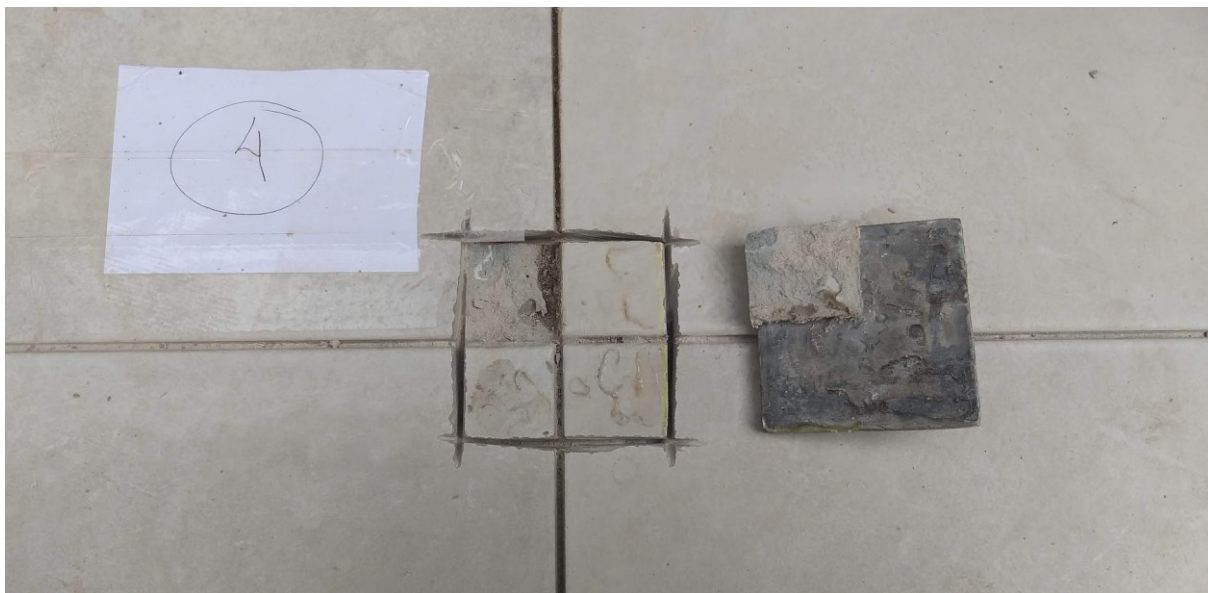
Figura 29 – Forma de ruptura do quarto corpo de prova da argamassa A
