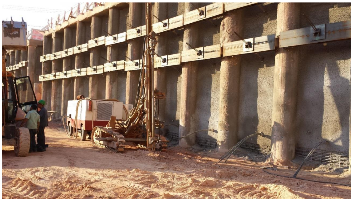
Figura 3.26 - 1º e 2º Linhas de tirantes construída executando a 3º Linha fechamento em concreto projetado.
