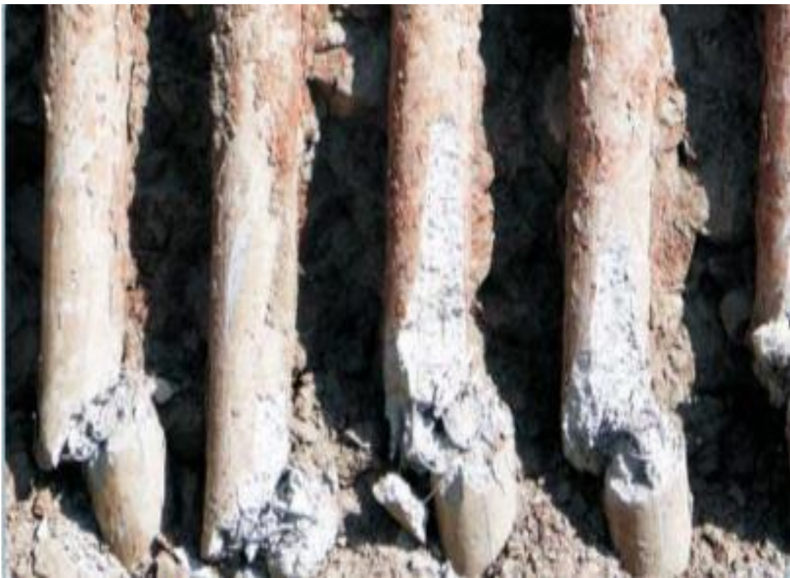
Figura 1.1 - Cortina de estacas rompida (CONSULTORIA E ANÁLISE, 2015)
