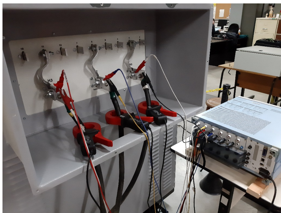
Figura C.11 – Ligação do analisador no transformador
