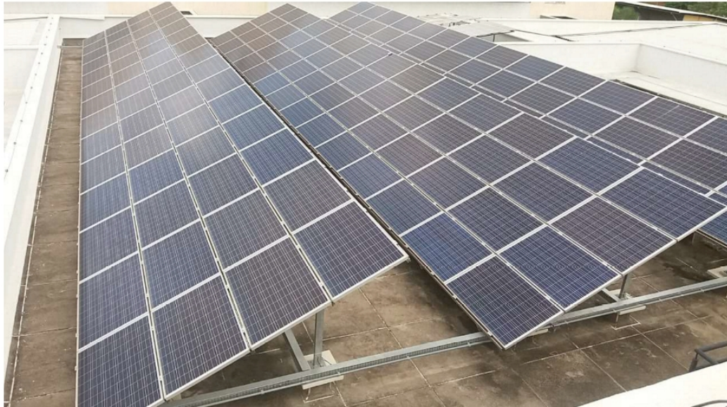
Figura 5.5 – Usina solar fotovoltaica TESLA.
