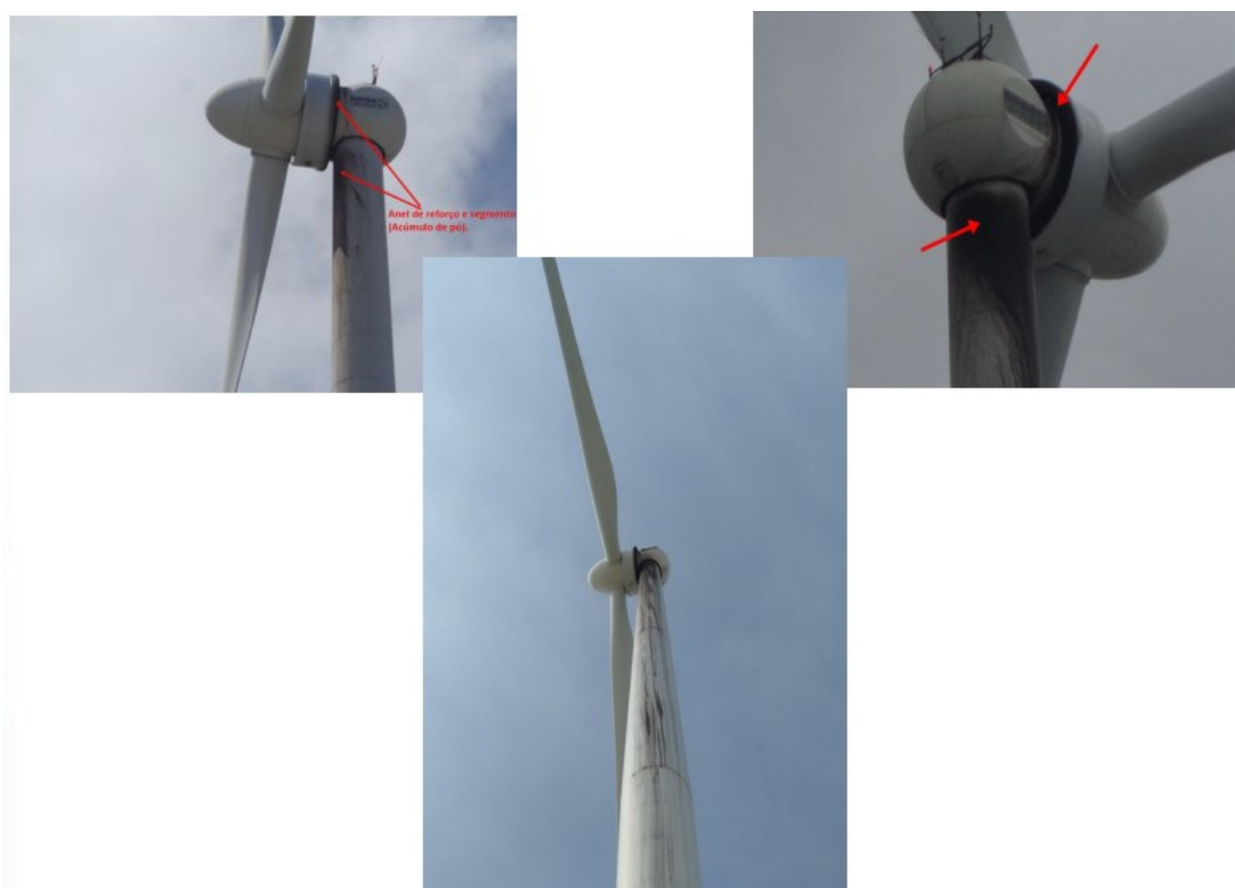
Figura 46 - Acúmulo de poeira no aerogerador e escorrendo pela torre (fonte: Empresa proprietária do parque).
