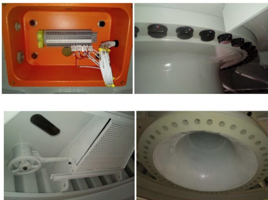
Figura 54 - Partes do Aerogerador após recuperação (Fonte: Empresa proprietária do parque)
