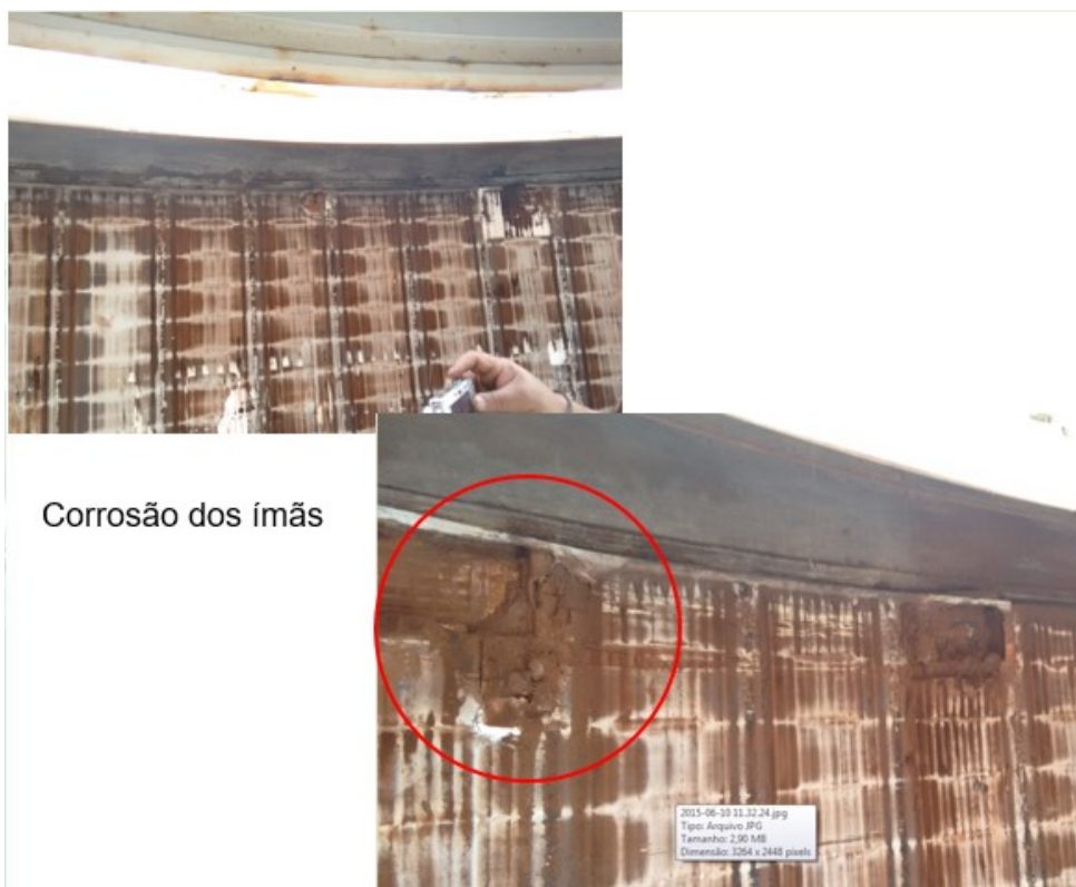
Figura 45 - Corrosão dos ímãs do rotor (fonte: Empresa proprietária do parque)
