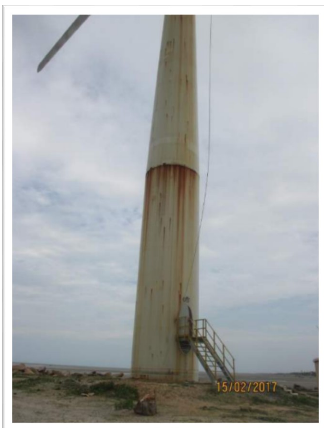
Figura 49 - Oxidação das torres (fonte: Empresa proprietária do parque)
