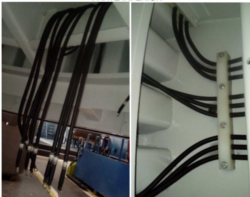
Figura 53 - Partes do Aerogerador após recuperação (Fonte: Empresa proprietária do parque)
