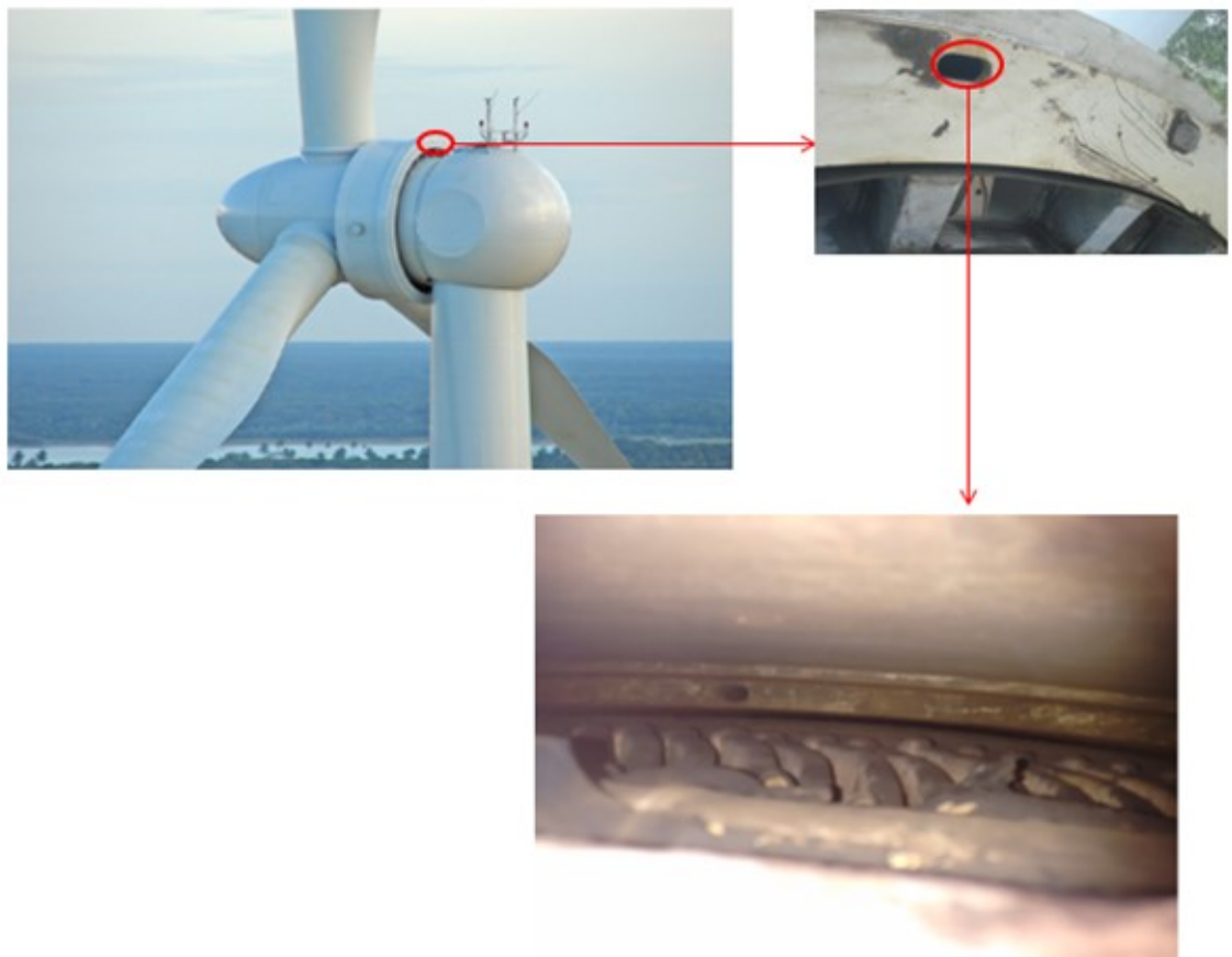
Figura 43 - Ponto de entrada de umidade e ocorrência de curto-circuito
