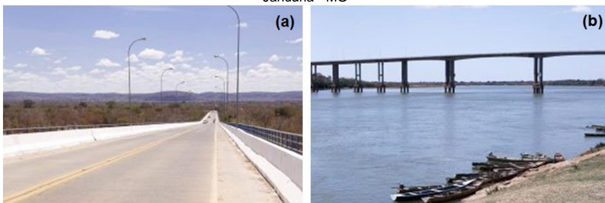
Figura 10: Ponte sobre o Rio São Francisco que interliga os municípios Pedras de Maria da Cruz e Januária - MG
