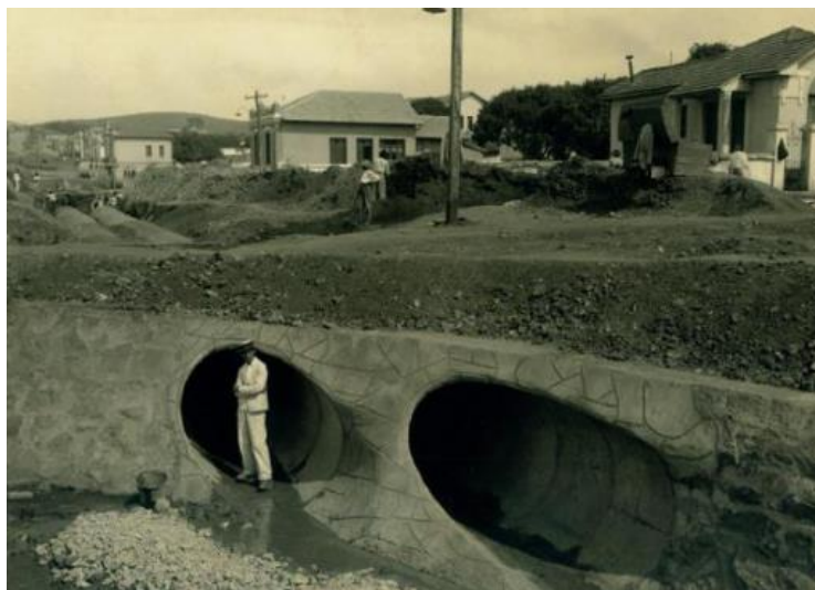
Figura 13 – Canalização concluída do Barroca e confluência com o Leitão no cruzamento entre as ruas Mato Grosso e Tupis e Avenida Bias Fortes
