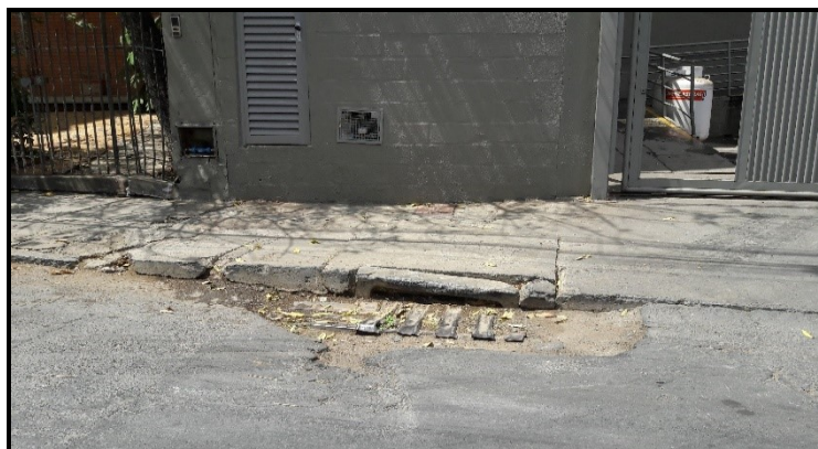
Figura 11 – Ponto de captação de água pluvial entupido - Bueiro – Rua Irmã Beata - Centro
