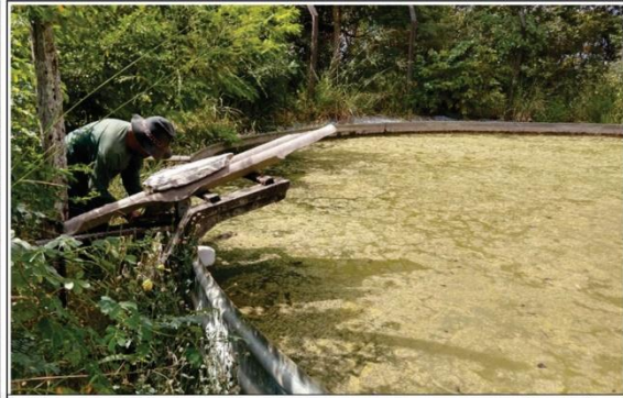
Reservatório do Poço da Fz. Lagoa Funda (ID-31)
