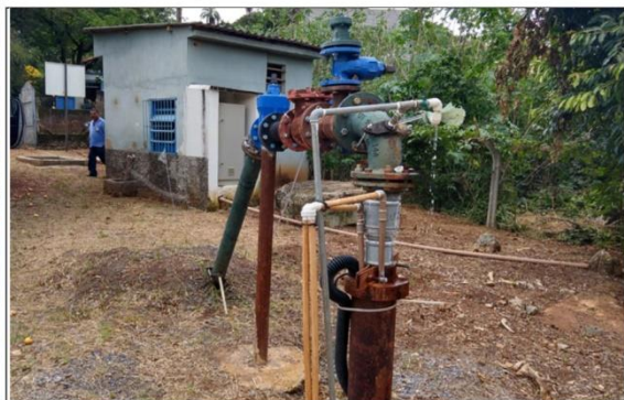
Poço E1 - Fidalgo Copasa (ID-9)
