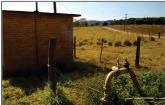
Poço Fz. Sto Antônio Cerca Grande PT1 (ID-15)
