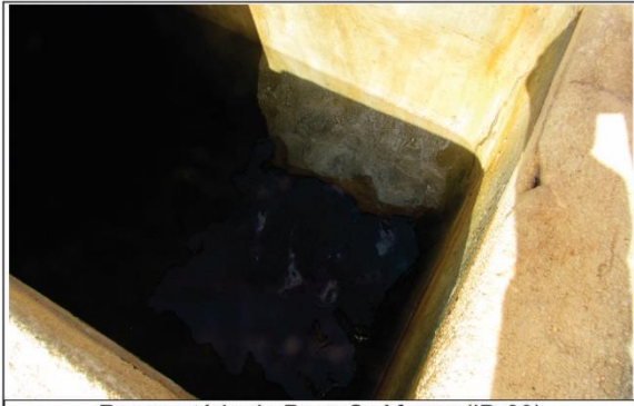
Reservatório do Poço Sr Afonso (ID-33)
