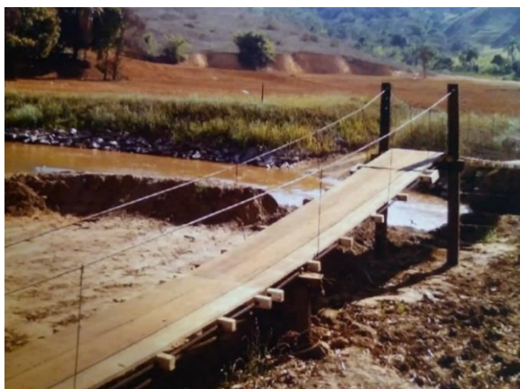
Figura 24 - Travessia em propriedade em Pedras após a passagem da lama
