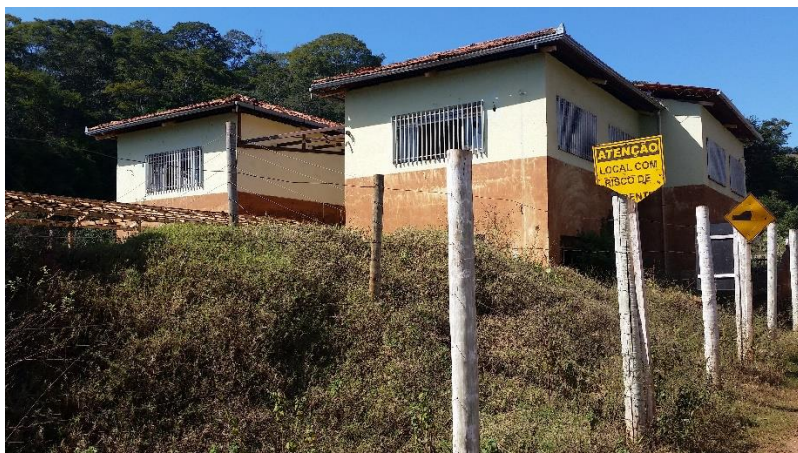
Figura 20 - Marcas da passagem da lama em residências de Paracatu de Baixo (2018)
