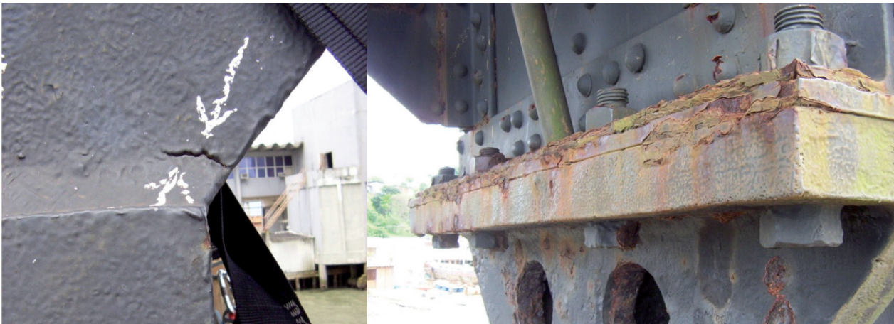
Figura 2 – Fissuras e elevado estágio de corrosão das bases dos pilones.
