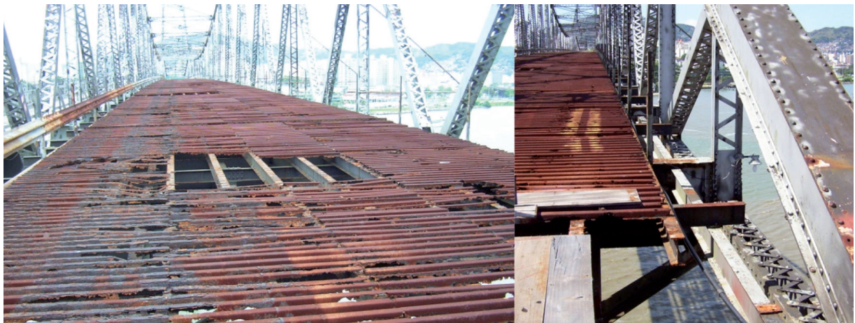
Figura 3 – Elevado estágio de corrosão do tabuleiro metálico.
