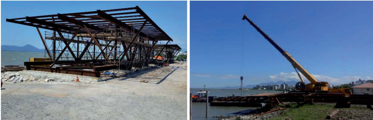
Figura 11 – (a) Pré-montagem da treliça da estrutura auxiliar no canteiro; (b) transporte das treliças em flutuantes.
