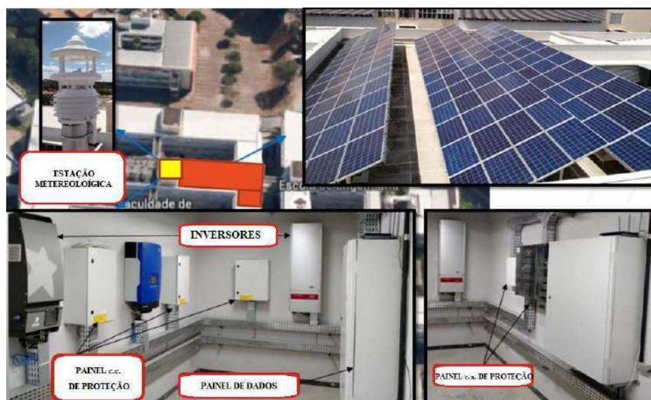
Figura 38 – Composição da planta fotovoltaica Tesla.
