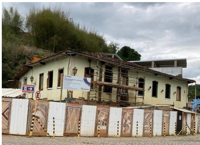
Figura 29 - Hotel Xavier aguardando restauração
