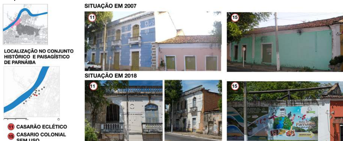
Figura 62 Estado de conservação de edificações no Conjunto Porto das Barcas - comparativo
