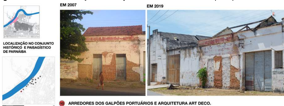
Figura 67 – Descaracterizações no Conjunto Porto das Barcas e Galpões portuários
