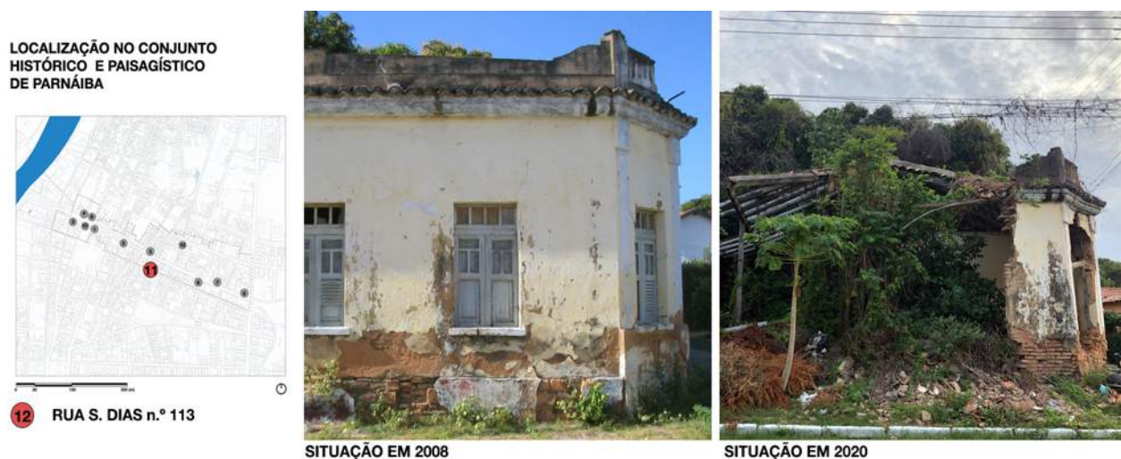
Figura 160 – Comparativo do estado de conservação Rua Simpício Dias n.º 113
