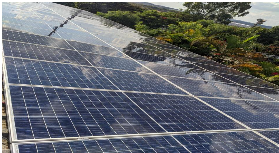
Figura 6.2 – Vista superior da empresa utilizada para o projeto, após a instalação dos módulos fotovoltaicos (Autor, 2020).
