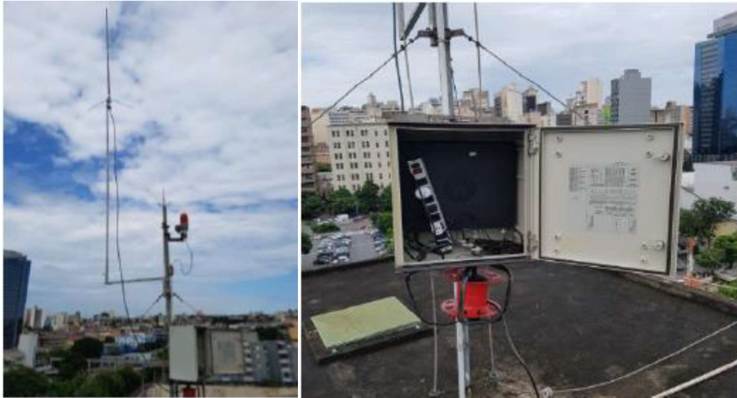
Figura A.3: Equipamentos do sistema de transmissão instalados em CCO.
