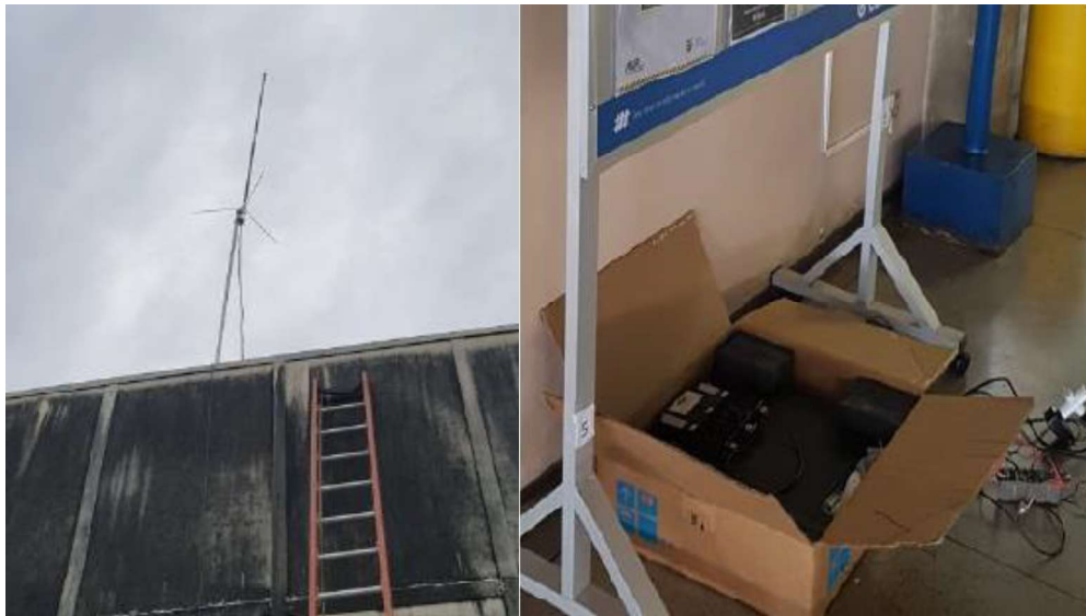
Figura A.13: Equipamentos do sistema de transmissão instalados em Calafate.
