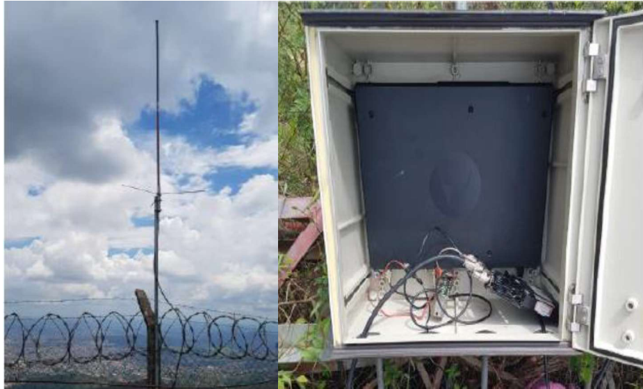
Figura A.9: Equipamentos do sistema de transmissão instalados em Centelha 1.
