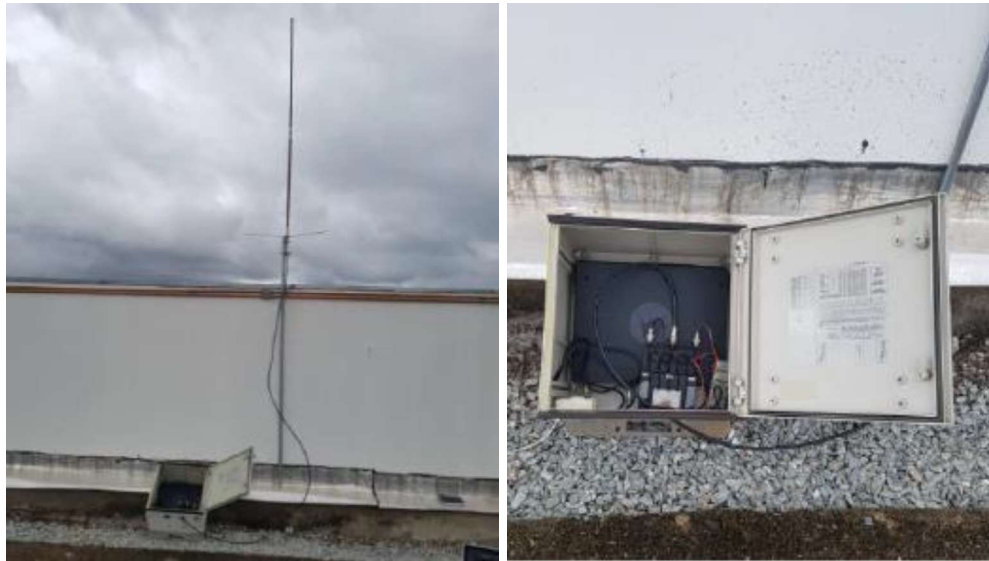
Figura A.7: Equipamentos do sistema de transmissão instalados em Vilarinho.
