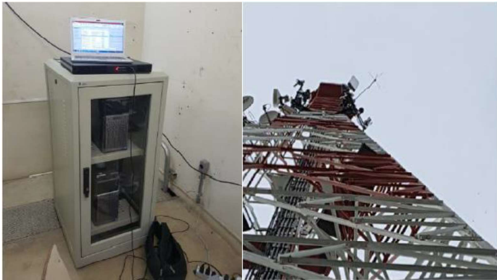
Figura A.1: Equipamentos do sistema de transmissão instalados em Minas Shopping.
