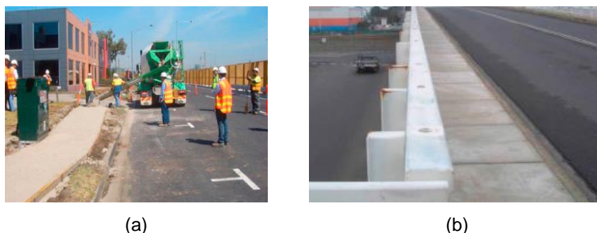
Figura 3.1.2 – (a) pavimentação E-Crete da Westgate Freeway em Port Melbourne e (b) painéis pré-moldados E-Crete VicRoads. Fonte: Nazari; Sanjayan (2017).
