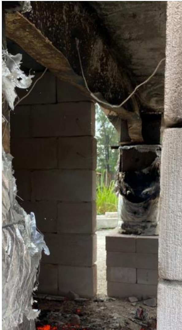
a) Viga ainda montada após o ensaio.
