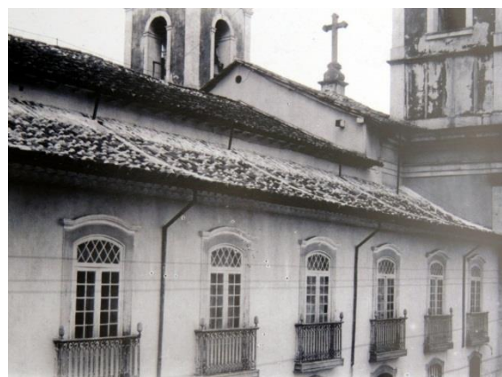
FIGURA 769: Telhado da Matriz de Nossa Senhora do Pilar, de São João del-Rei-MG, com as telhas embocadas. Fotografia acervo da SR-IPHAN, Belo Horizonte-MG, década de 1940.
