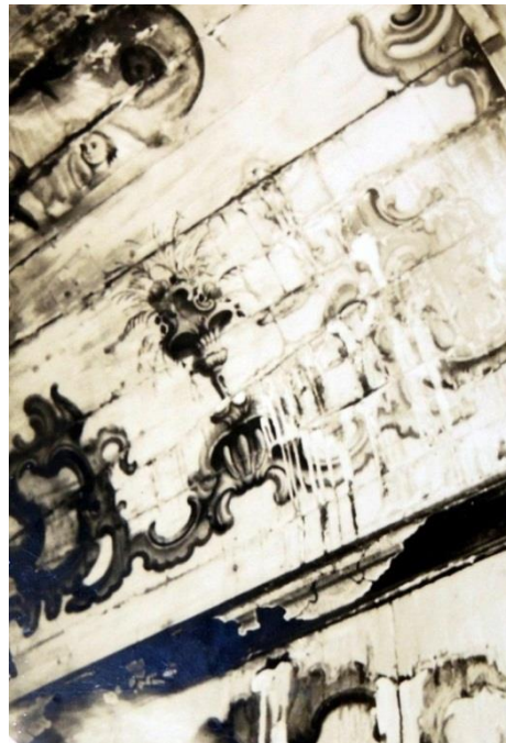
FIGURA 677: Detalhe do camarim do retábulo-mor, da Capela de Nossa Senhora da Penha de França, Bichinho, Prados-MG. Pintura atingida por águas pluviais. Obra atribuída a Manoel Victor de Jesus. Fotografia CCRTAEM, IPHA-RJ, 1971.
