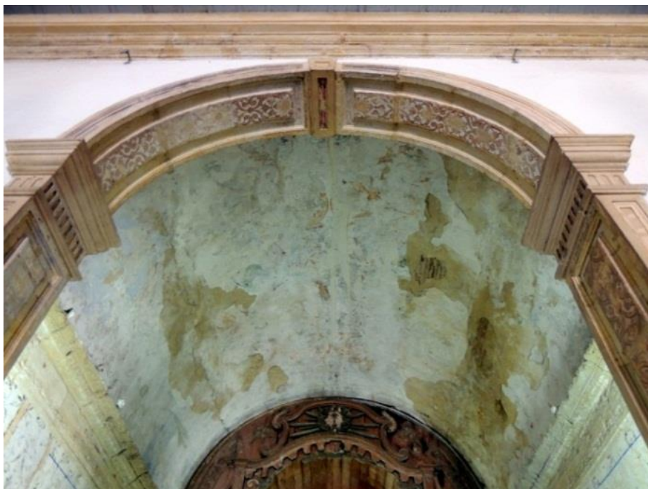
FIGURA 222: Teto da capela-mor de Igreja de São Cosme e Damião, em estuque, com pintura brutescada, em crítica situação de conservação. Igarassu-PE. Fotografia do autor, 2020.
