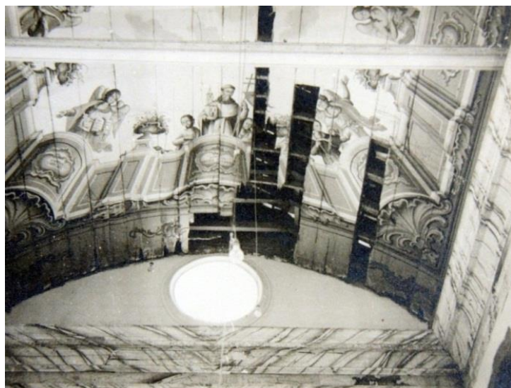
FIGURA 640: Detalhe do teto da nave da Capela de Nossa Senhora das Mercês, antes da primeira intervenção de restauração, realizada pelo IPHAN, década de 1960. CCRTAEM, IPHAN-RJ.
