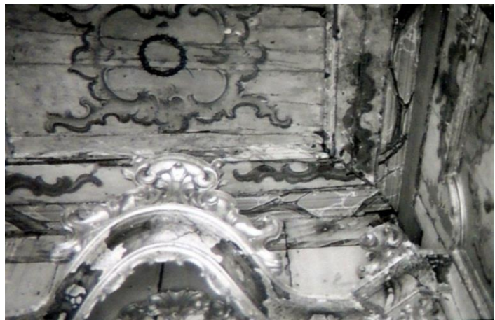
FIGURA 182: Detalhe do interior do Passo da Paixão da Rua Direita, bem degradado pelas águas pluviais e ataque de insetos. Fotografia do autor, 1982.
