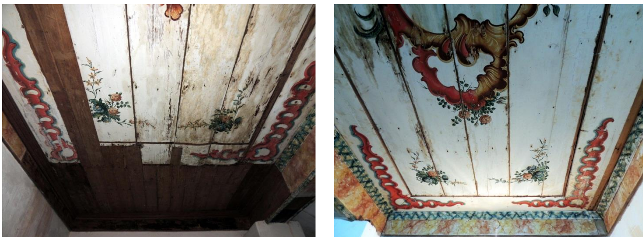
FIGURAS 447,448: Extremos de um dos módulos do teto, com a substituição dos suportes pictóricos. Atribuída a Manoel Victor de Jesus. Têmpera sobre madeira, séc. XVIII/XIX. Fotografias do autor, 2019.
