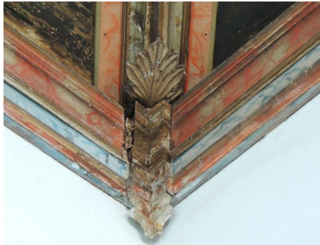
FIGURA 143: Detalhe da cimalha, canto do teto em gamela, com recorte em carapina e palmeta. Fotografia do autor, 2017.
