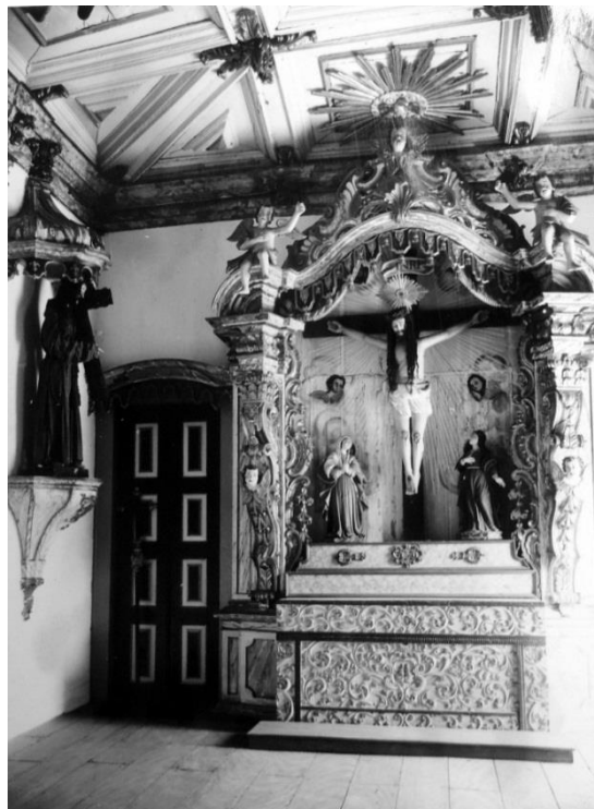
FIGURA 459: Detalhe do teto do Consistório da Irmandade do Senhor dos Passos com repintura. Acervo CCRTAEM-IPHAN, Rio de Janeiro, década de 1960.
