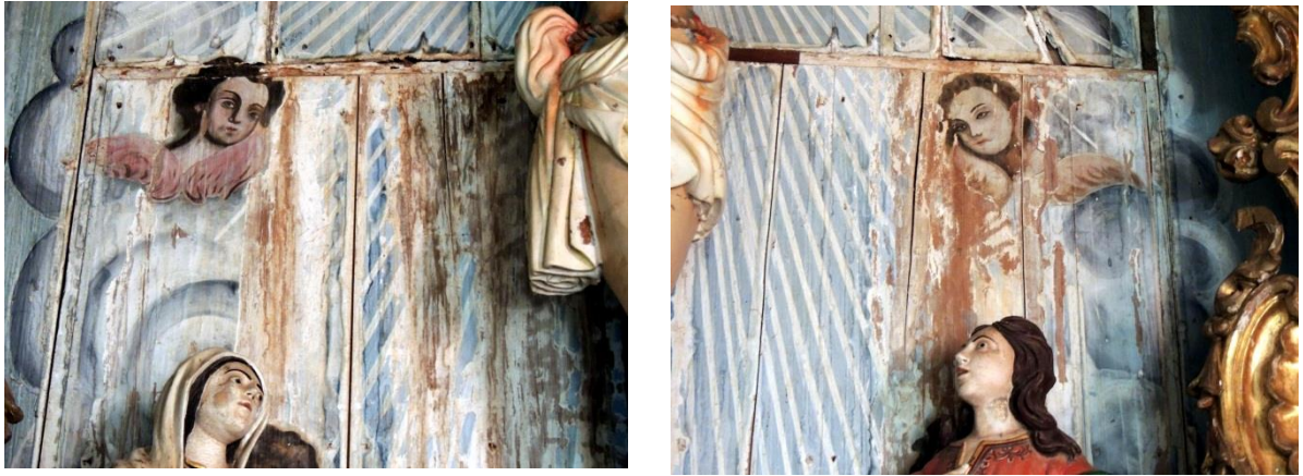
FIGURAS 467,468: Aspectos da pintura do fundo do retábulo, atingida por águas pluviais. Autoria desconhecida, têmpera sobre madeira, século XIX. Consistório da Irmandade do Senhor dos Passos. Matriz de Santo Antônio. Fotografias do autor, 2019.
