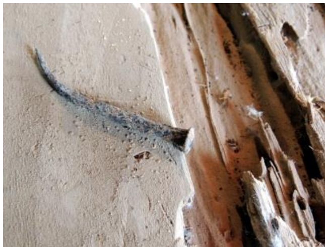
FIGURA 161: Início dos trabalhos de restauração dos tetos pintados da Casa do Largo do Ó, nº 1, Tiradentes-MG, galeria aberta pelos insetos xilófagos. Fotografia do autor, 2017.
