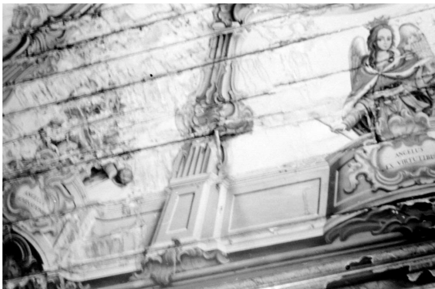
FIGURA 678: Detalhe do teto da capela-mor da Capela de Nossa Senhora da Penha de França, Bichinho, Prados-MG. Pintura atingida por águas pluviais. Obra atribuída a Manoel Victor de Jesus. Fotografia CCRTAEM, IPHAN-RJ, 1971.
