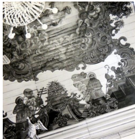
FIGURA 774: Aspectos do teto da nave da Matriz de Nossa Senhora do Pilar, São João del-Rei-MG, antes da primeira restauração. Fotografia do acervo da SER-IPHAN, Belo Horizonte-MG, 1954, sem ref. de autoria.
