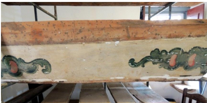
FIGURA 475 : Teto do vestíbulo da esquerda, durante o processo de restauro, ocorrido na Capela de Nossa Senhora do Rosário. Fotografia do autor, 2019.
