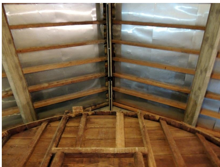
FIGURA 327: Madeirame do telhado da Matriz de Santo Antônio, com chapas metálicas para a proteção contra as goteiras. Fotografia do Autor, 2019.
