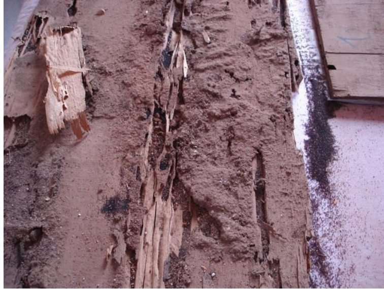
FIGURA 120: Aspecto da conservação de um dos tetos da Casa Padre Toledo, com acúmulo de sujidades carreadas pelas águas pluviais e ataque de insetos. Fotografia do autor, 2010.
