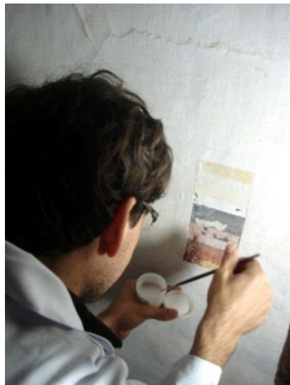
FIGURAS 109,112: Pintura de fingimento, barrado e adamascado da Casa Padre Toledo, durante e depois da consolidação. Têmpera sobre reboco, autoria desconhecida, século XVIII. Fotos do autor, 2012.
