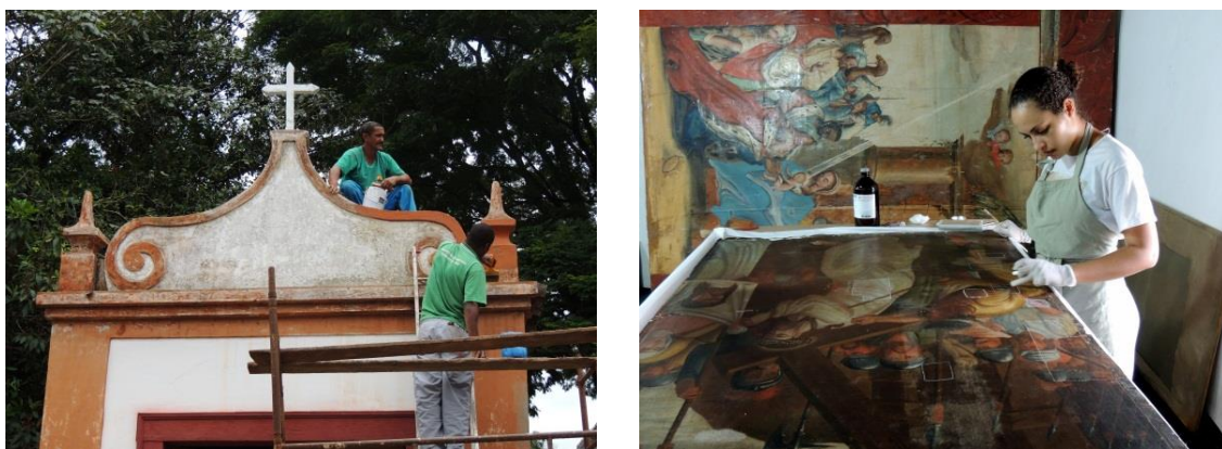
FIGURAS 193,194: Aspectos da obra de restauro estrutural e artístico do Passo da Paixão da Rua Direita, realizada entre 2015-2018. Fotografias do autor, 2017 e 2018.
