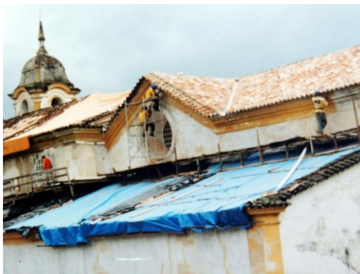
FIGURA 466: Aspecto da obra de restauração estrutural e cobertura da Matriz de Santo Antônio. A parte coberta por lona azul é o Consistório da Irmandade do Senhor dos Passos. Fotografia do autor, 2001.
