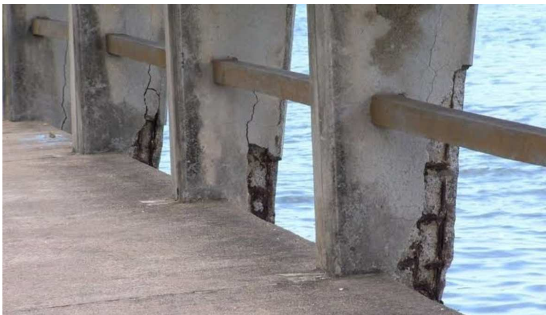
Figura 3.7 – Fissuração e deslocamento da camada de cobrimento em estruturas de concreto litorâneas.
