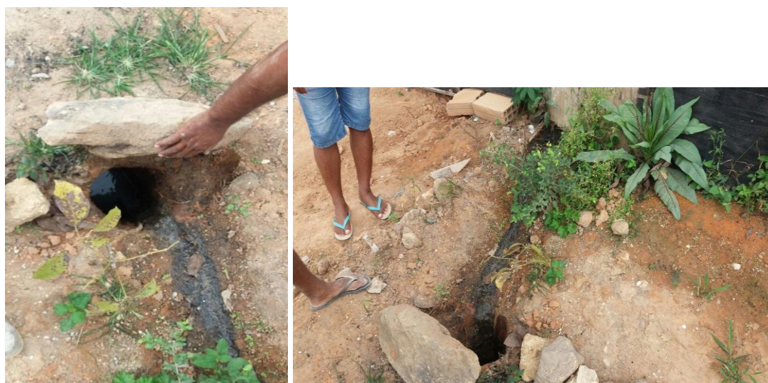
Figura 9: Dispositivo de tratamento de águas residuais desenvolvido por um dos moradores Fonte: Elaboração Própria
