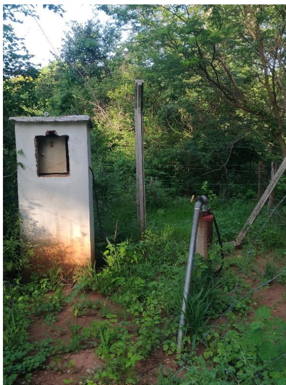
Figura 6: Poço artesiano na comunidade de Olhos d'água Estiva.
