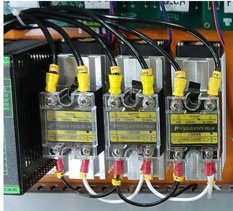
Figura 3.5 – SSRs utilizados para by-pass do FAS quando sua operação não é necessária
