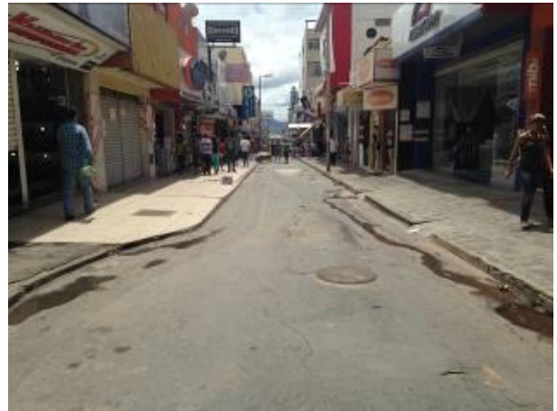
(d) calçada irregular/mudança de piso
