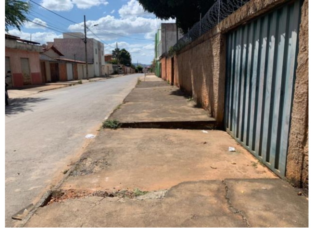
(f) calçadas irregulares/degraus
