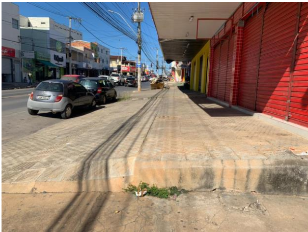
(e) calçada com desníveis acentuados
