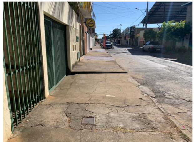
(b) calçadas com buracos e desníveis
