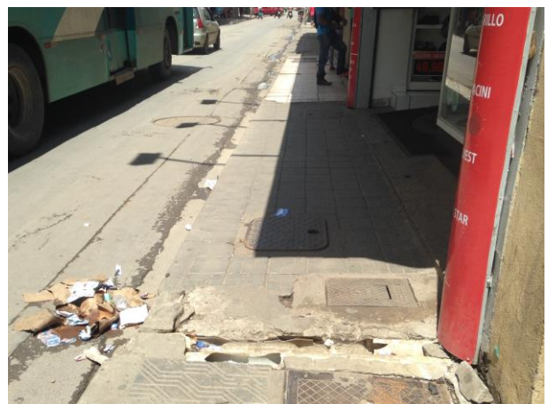
(f) calçada sem manutenção e com buracos
