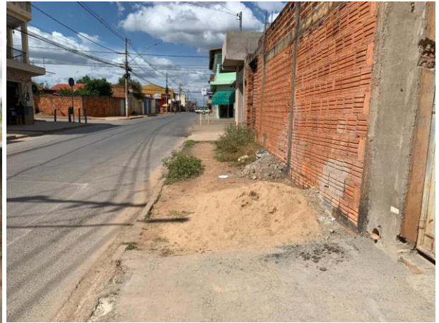
(b) inexistência de pavimento na calçada
