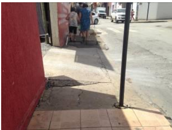
(e) calçada irregular/obstáculos
