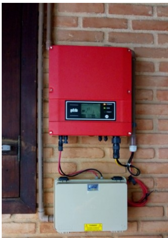
Figura 17 - Inversor e String box
