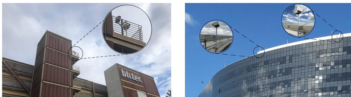
Figura 4.9: Câmera Bosch AUTODOME IP 5000 instalada em um poste no terraço do prédio institucional do BH-TEC (à esquerda). Duas câmeras Bosch NBN-832V DINION IP instaladas no terraço do Edifício Gerais da CAMG (à direita).
