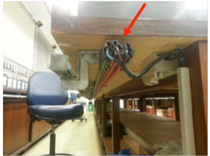
Figura 3: Visualização inferior de bancada e barramento elétrico associado
