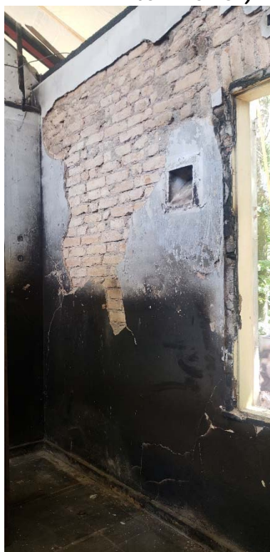
FIGURA 74 - Sala B: presença de fuligem na parede (parte inferior)
