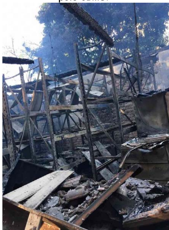
FIGURA 78 - Vista da sala B após a contenção das chamas pelo CBMG.
