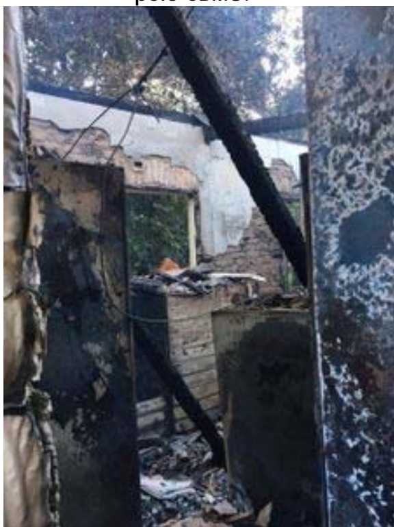
FIGURA 77 - Vista da sala A após a contenção das chamas pelo CBMG.
