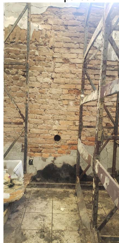
FIGURA 76 - Sala A: ausência de fuligem na parede.
