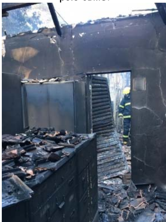
FIGURA 79 - Vista da sala C após a contenção das chamas pelo CBMG.
