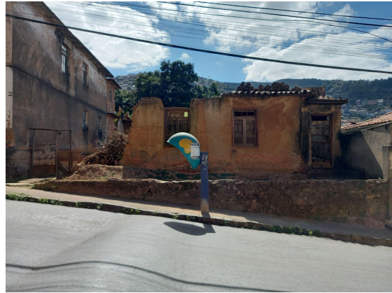
Foto 46: Edificação de número 299 na Rua Desidério de Matos, já em estado avançado de arruinamento, que vem sendo disputada entre vizinhos do bairro.
