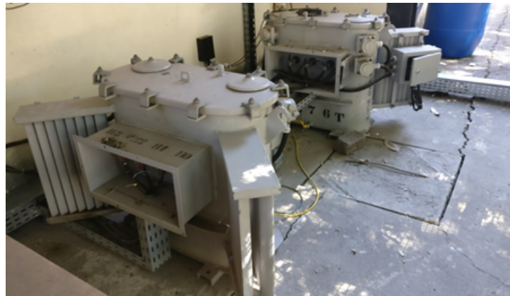
Figura 2.9: Equipamento sob teste - Transformador de potência
