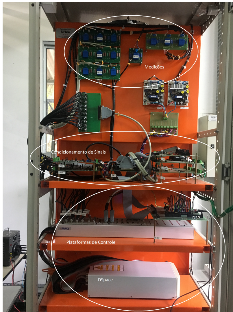
Figura 2.8: Fotografia da parte frontal do painel do sistema
