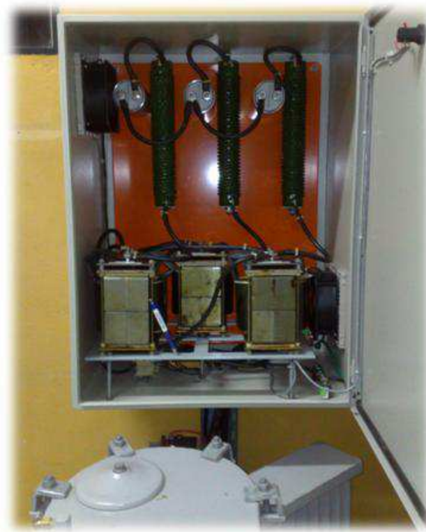
Figura 2.5: Fotografia de um dos filtros LC construídos
