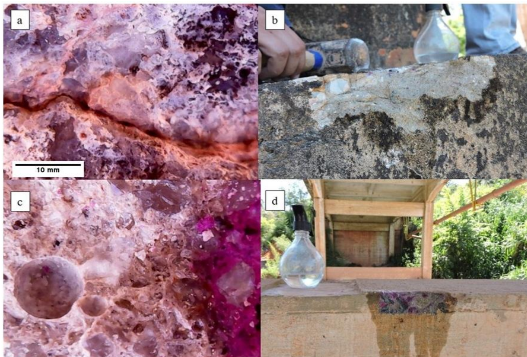
Figura 23 - Obra B bloco de fundação de coroamento (BFC1), (a) foto da lupa, (b) foto normal, Viga de ligação do rio (VLR2), (c) foto da lupa, (d) foto normal.
