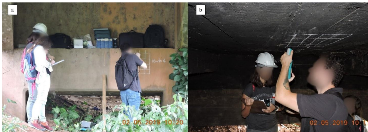
Figura 32 - OBRA/A, Viga da cortina 2VC (a) e Laje da cortina 9LC (b)
