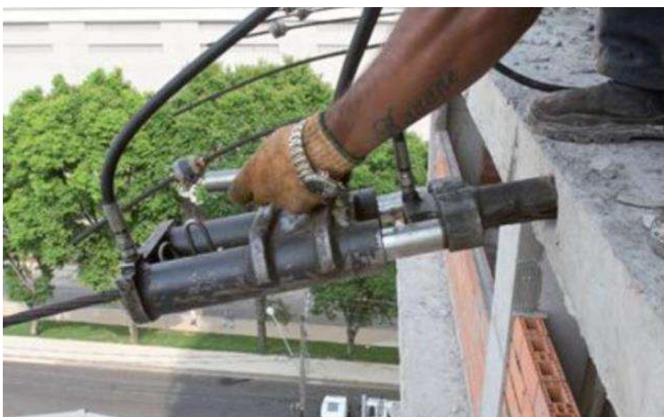
Figura 27: Foto da execução da protensão dos cabos, com auxílio do macaco hidráulico. Fonte: Clube do Concreto, 2018.
