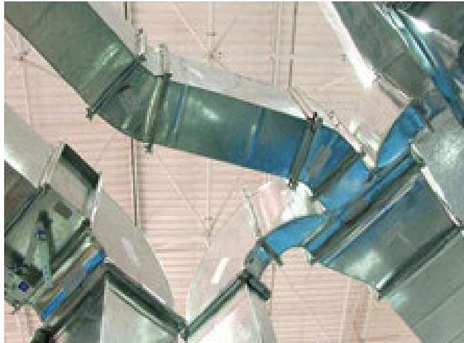
Figura nº 2.8 - Duto em chapa galvanizada – Fonte: www.coupear.com.br
