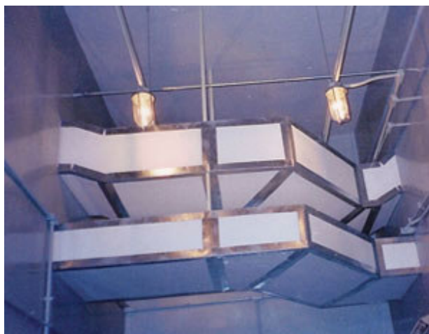
Figura nº 2.7 - Duto em chapa isolado em poliestireno
