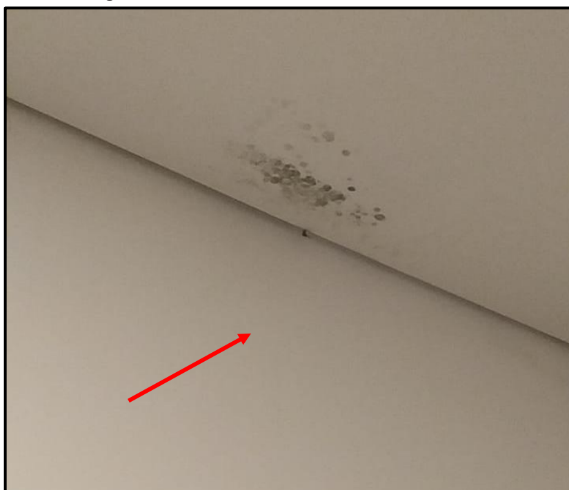
Figura 26 - Mancha no teto devido a infiltração
