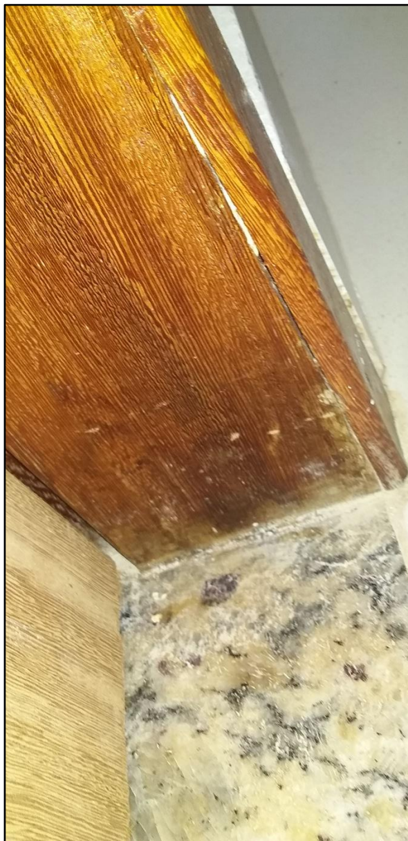
Figura 16 – Mal assentamento do alisar e manchas no marco
