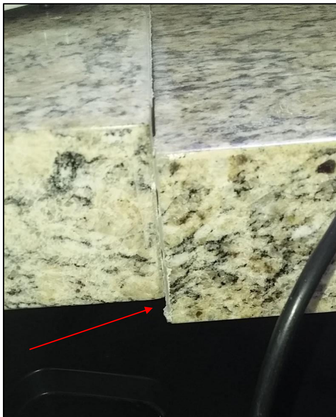
Figura 12 – Deslocamento da bancada da pia da cozinha
