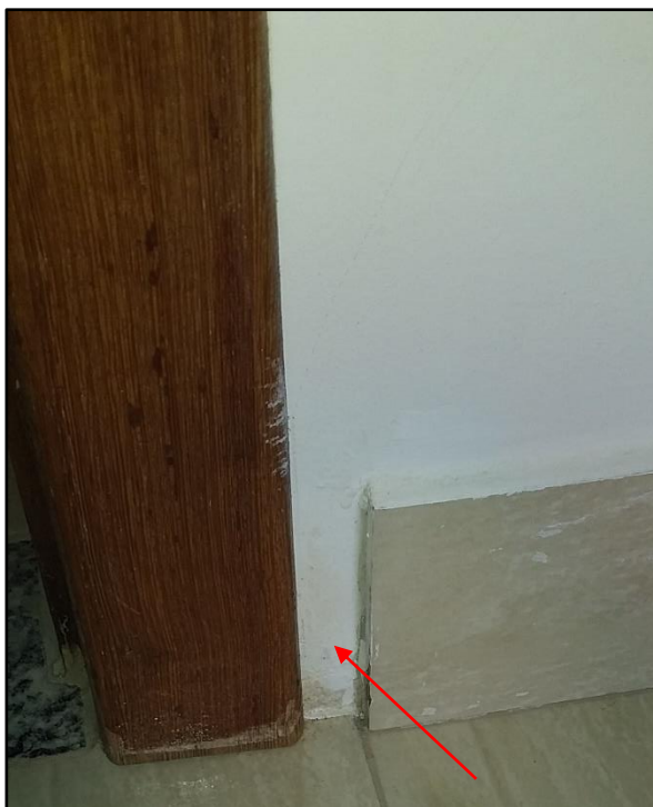
Figura 23 – Falta de complemento do rodapé
