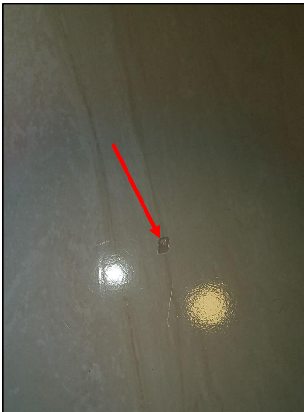
Figura 20 – Piso cerâmico do imóvel danificado
