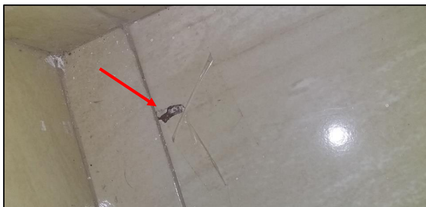
Figura 19 – Piso cerâmico do imóvel danificado
