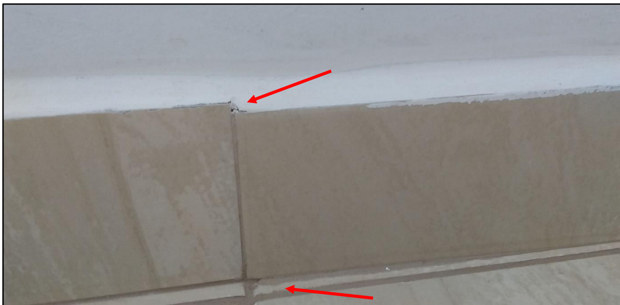
Figura 22 – Mal assentamento do piso e rodapé
