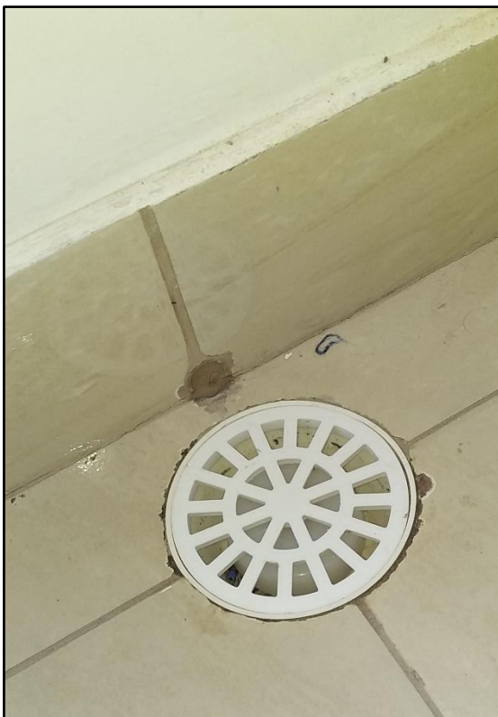
Figura 21 – Danos no piso e má execução do rejunte
