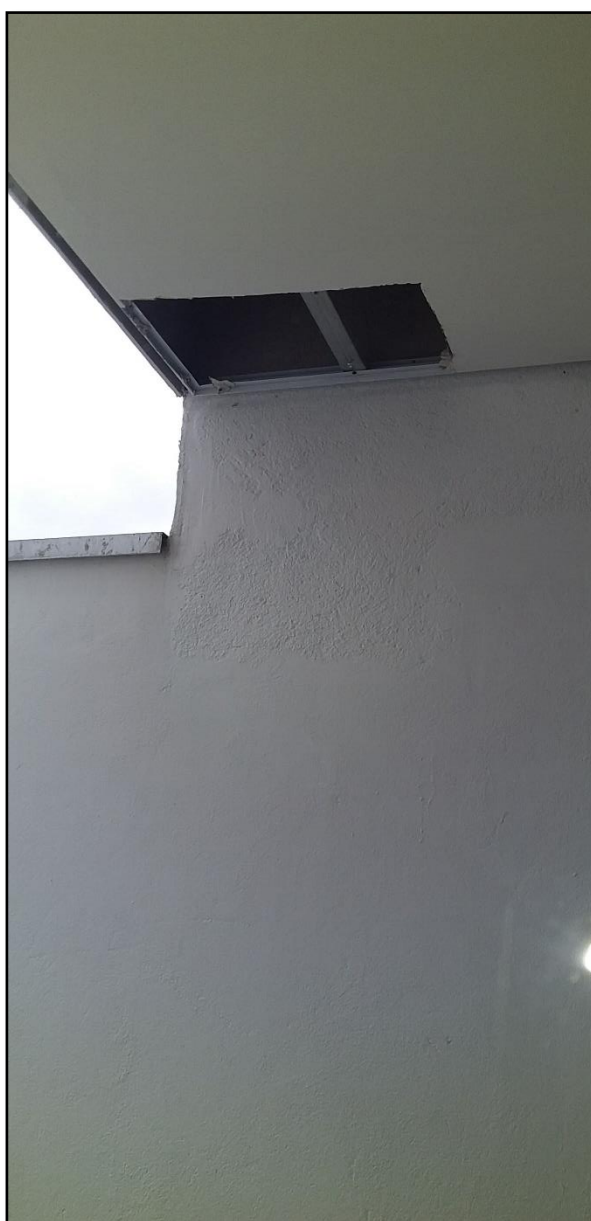
Figura 10 – Forro danificado devido a vazamentos
