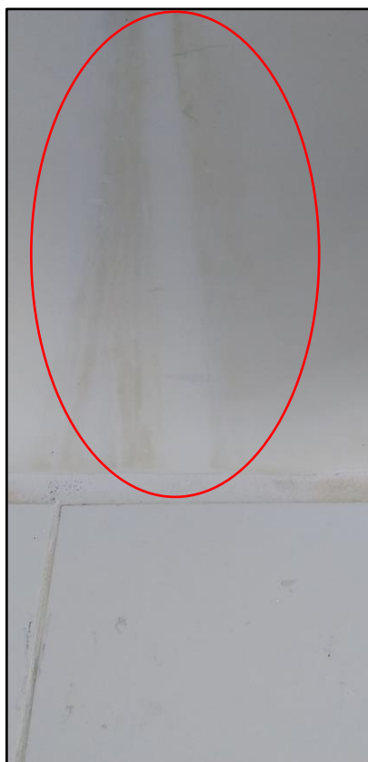
Figura 27 - Mancha devido a infiltração
