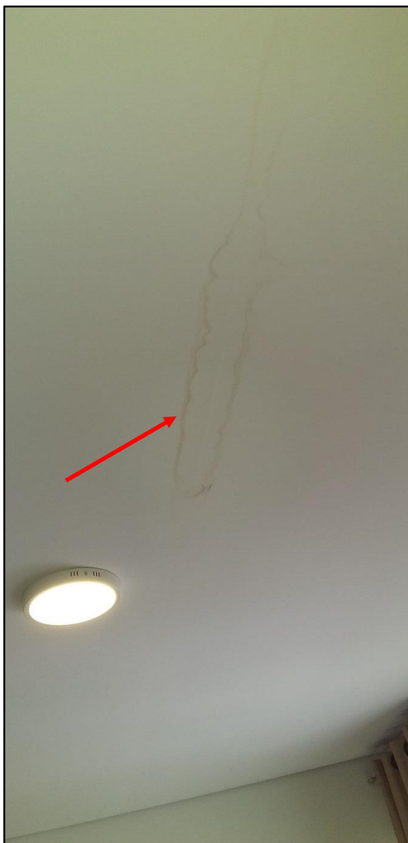
Figura 28 - Mancha no teto devido a infiltração
