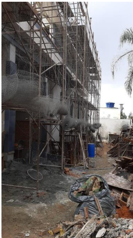
FIGURA 33 – Canteiro de obra mostrado por Ari. FONTE: Foto de autoria do construtor Ari. Arquivos da disciplina “O desenho do canteiro”
